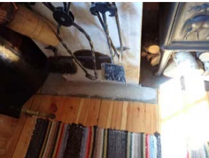
Oversikt ved sotluke.
