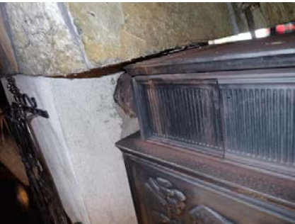
Liten avstand mellom vedovn og ubrennbart materiale på oversiden.
