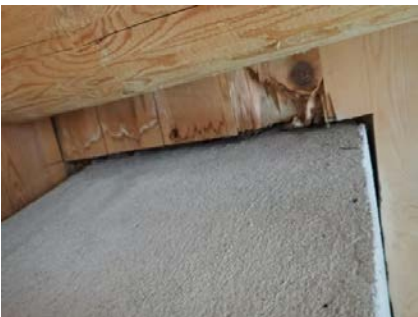
Misfarging i takpanel i overkant av pipe.
