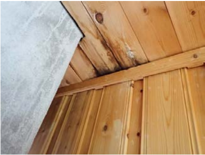
Misfarging i takpanel i nedkant av pipe.
