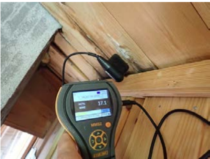
Fuktmålingen indikerer skader.
