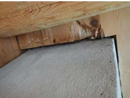
Indikasjon på lekkasjer ved pipe.
