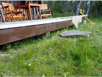
Tydelig skjevhet i konstruksjonen.
