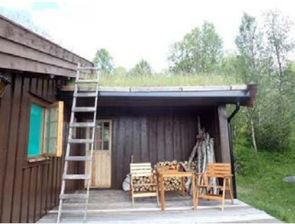
Tydelig nedbøying i konstruksjonen.
