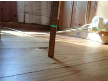
Skjevhet på innvendig gulv. Målt til ca. 29 mm.
