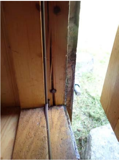
Sprekk i dørkarm.
