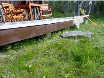
Tydelig skjevhet i konstruksjonen.
