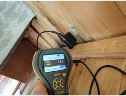
Fuktmålingen indikerer skader.
