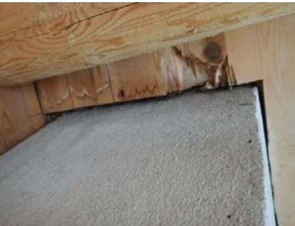
Misfarging i takpanel i overkant av pipe.
