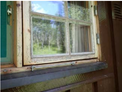
Slitasje/misfarging i vinduskarm.
