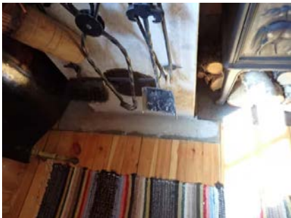
Oversikt ved sotluke.
