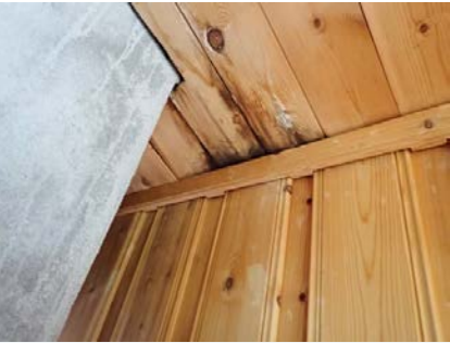
Misfarging i takpanel i nedkant av pipe.
