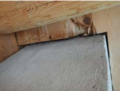
Indikasjon på lekkasjer ved pipe.
