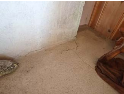
Sprekker i peismur.
