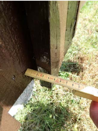
Kledningsbord som ikke tetter mot underligger.
