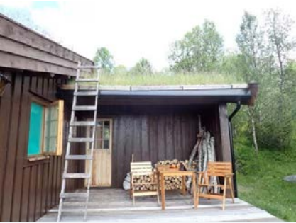
Tydelig nedbøying i konstruksjonen.
