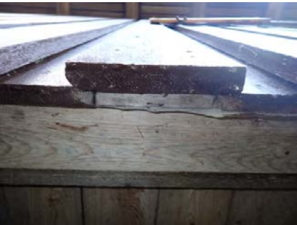
Begrenset/manglende lufting mellom kledning og veggkonstruksjon.
