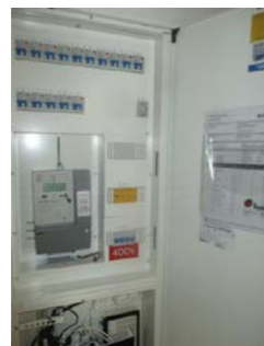
Sikringskapet er plassert i hall.
