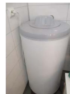
Bereider er plassert på vaskeromsdelen.
