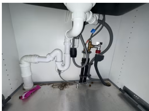
Viser vann og avløpsinnstallasjoner under kum.
