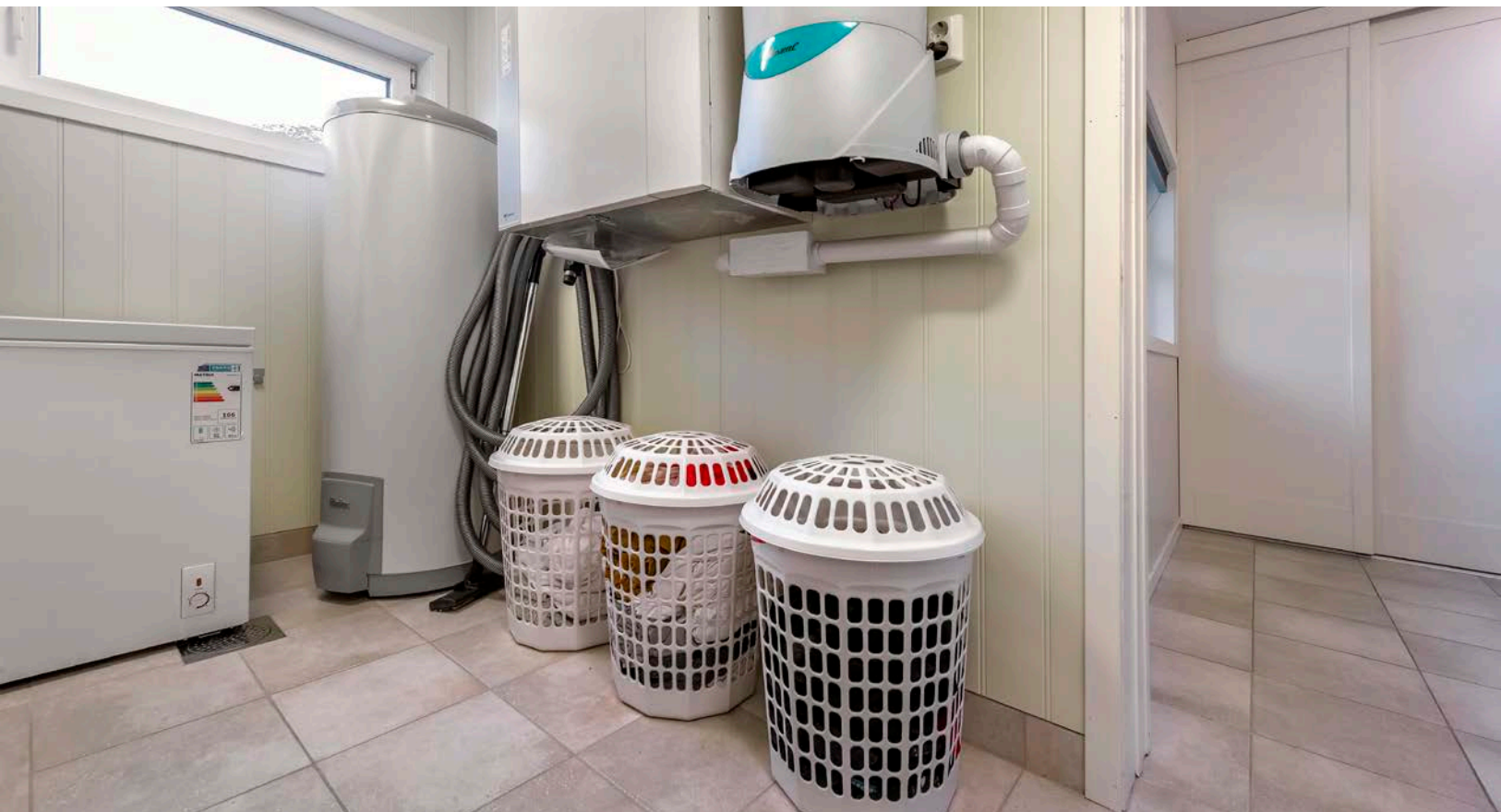
Vaskerom/teknisk rom (1. etasje)
