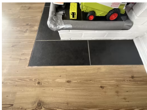
Mindre svelleskade på gulv og boom under flis.
