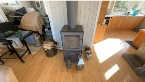
Montert ovn i stue.
