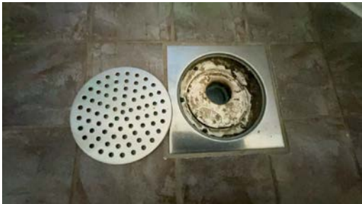
Sluk i gulv.
