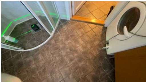
Del av gulv. Målt fall på gulv.
