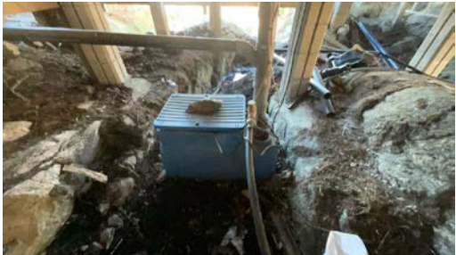
Tank med kværnepumpe.
