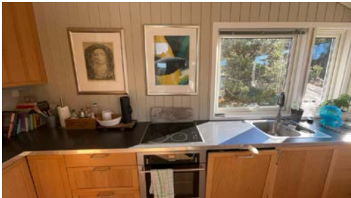
Det er ikke montert avtrekk.
