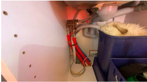
Del av rør til vann.
