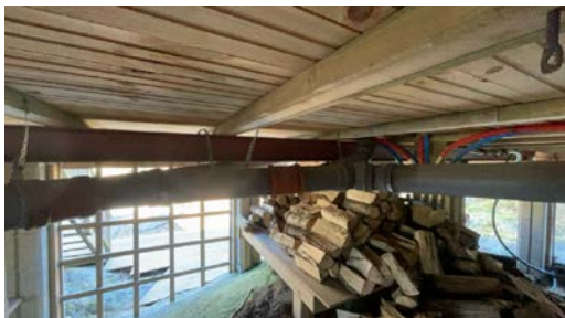
Del av rør til avløp.
