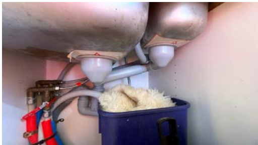
Del av rør til avløp.
