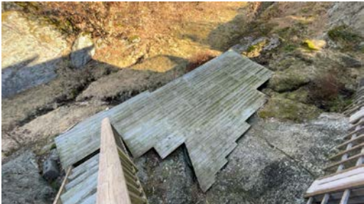
Del av terrasse. Det er ikke montert rekkverk.
