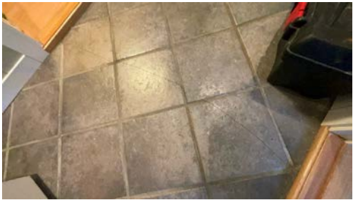
Del av gulv. Sprekk i flis.
