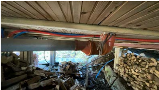
Del av rør til avløp.
