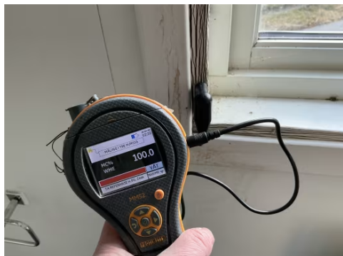
Ved fukt-søk er det Registrert forhøyede målinger.
