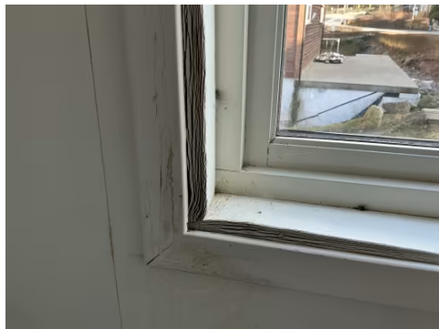
Svelling/fukt-skade på vindu i bad.
