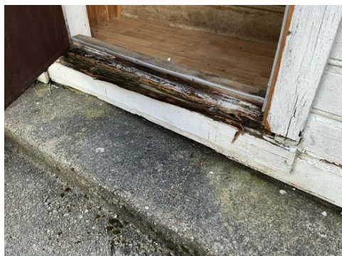
Fukt/råteskade på inngangsdør.
