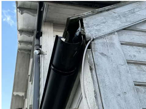
Skade på tak-renne og ende-stykke megler.
