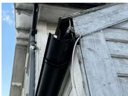
Skade på tak-renne og ende-stykke megler.
