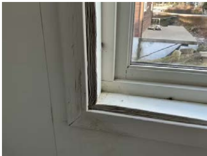
Svelling/fukt-skade på vindu i bad.
