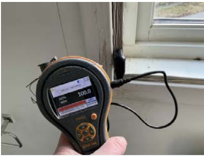
Ved fukt-søk er det Registrert forhøyede målinger.
