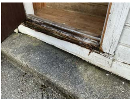
Fukt/råteskade på inngangsdør.
