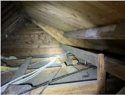
Det er ikke isolasjon i tak mot kaldt loft.
