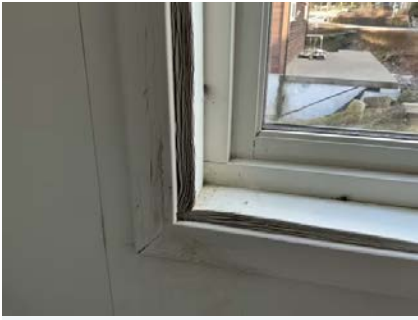
Svelling/fukt-skade på vindu i bad.
