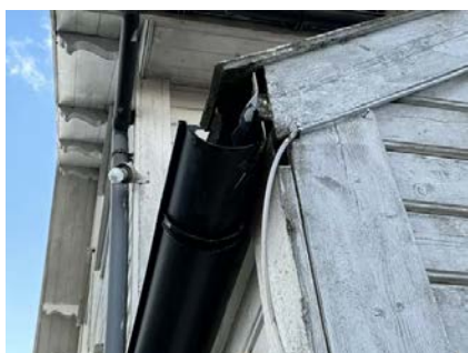
Skade på tak-renne og ende-stykke megler.
