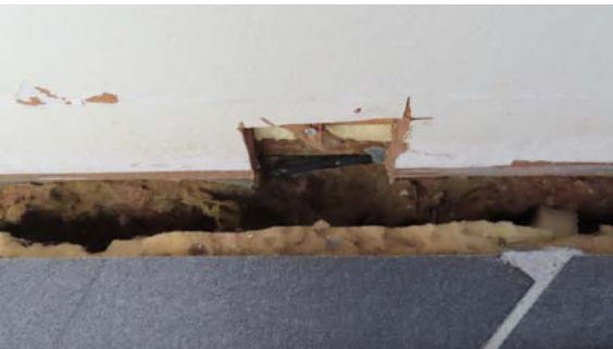
Glipe mellom gulv og vegg ved spisestue.
