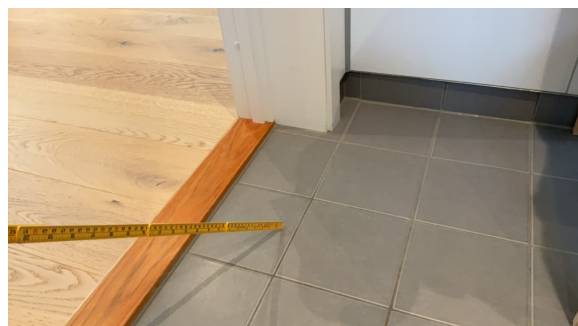
Bom/hulldyd på 5 fliser ved dør.
