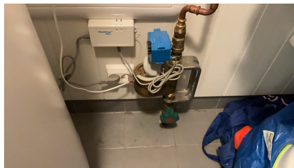
Stoppekran plassert på teknisk rom.
