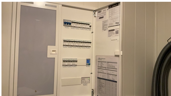
Sikringsskap plassert på teknisk rom.
