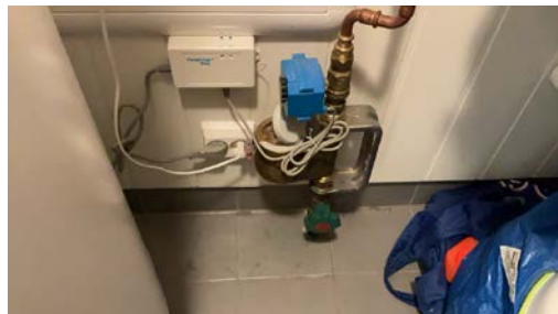
Stoppekran plassert på teknisk rom.
