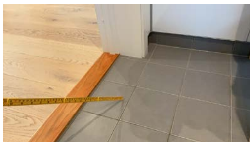
Bom/hulldyd på 5 fliser ved dør.
