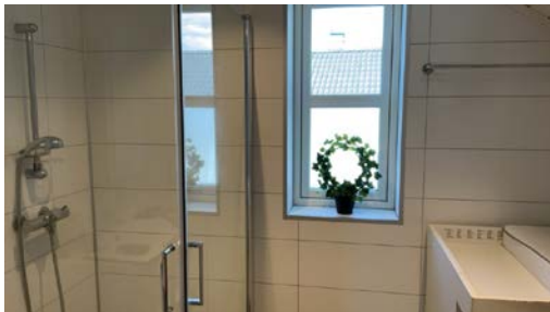
Vindu plassert i våtzone.
