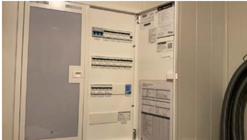
Sikringsskap plassert på teknisk rom.
