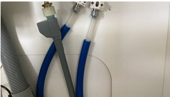
Manglende tettemuffer på kjøkken.
