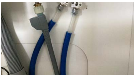
Manglende tettemuffer på kjøkken.
