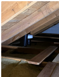
Det er montert vakumventil på luftingen til avløpsrøret.
