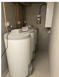
Varmtvannsberedere i teknisk i kjelleren.
