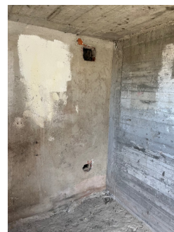
Hull i lufteløp, som ikke er tettet i kjelleren.
