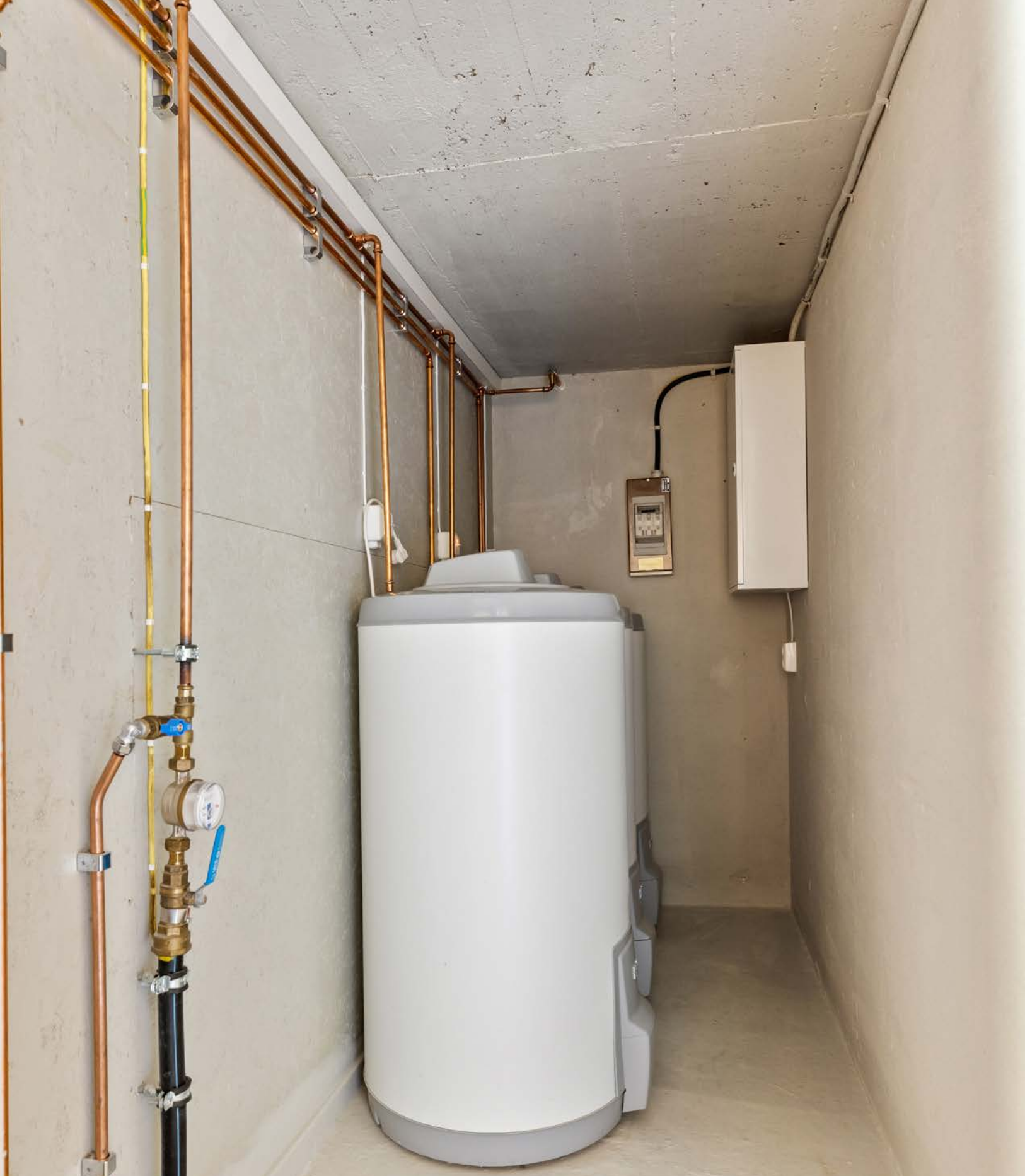
I kjelleretasjen er det innredet teknisk rom med 3 varmtvannstanker, en til hver etasje og sikringskap til kjelleretasjen.
