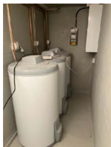
Varmtvannsberedere i teknisk i kjelleren.
