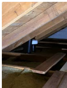
Det er montert vakuumventil på luftingen til avløpsrøret.
