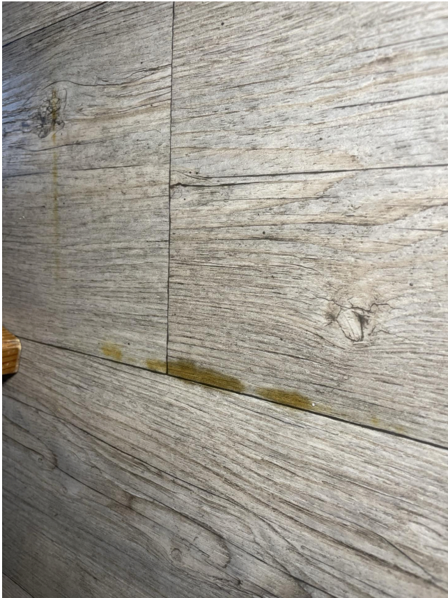
Flekker på overflaten.
