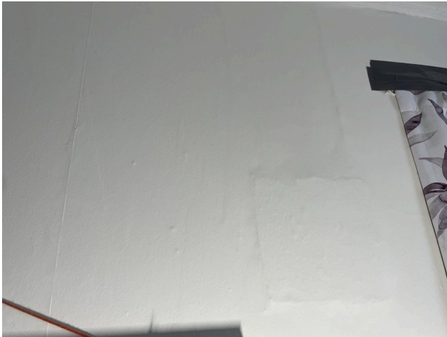
Skader på overflaten.
