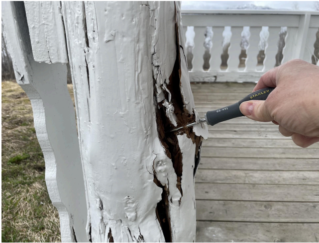
Store synlige skader i bærekonstruksjonen.
