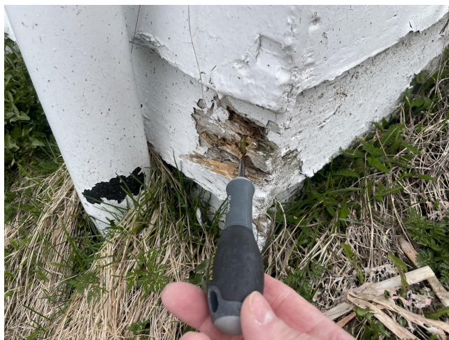
Råteskader på kledning.
