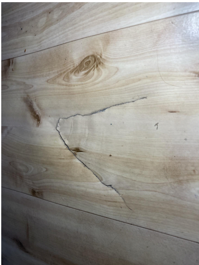
Skader på overflaten.
