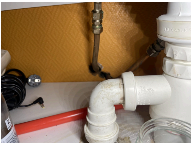
Gjennomføringer i våtsone vegg er ikke korrekt utført.
