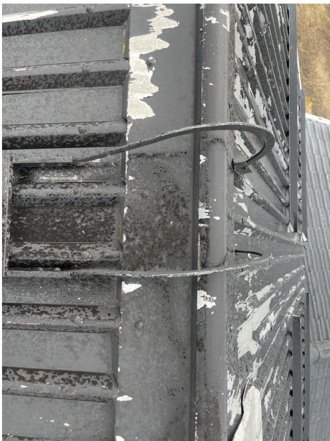
Takstige mangler vannfaste skruefester egnet for utendørs bruk.
