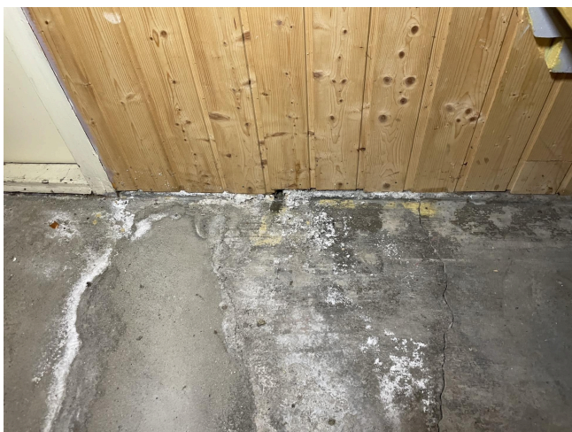
Ubehandlet betonggulv med synlige fuktskader.
