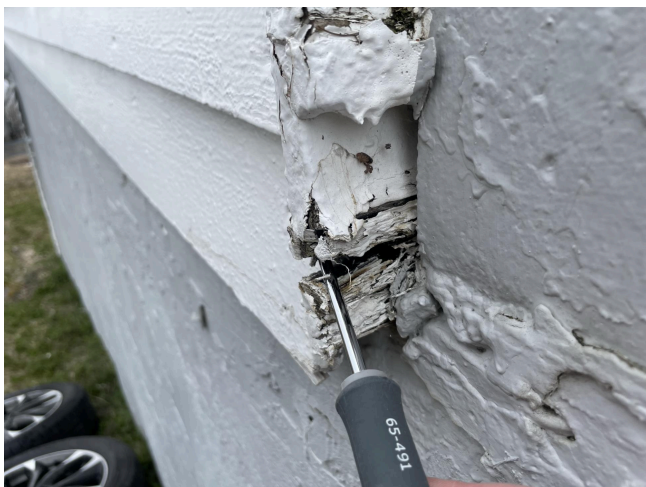
Råteskader på kledning.
