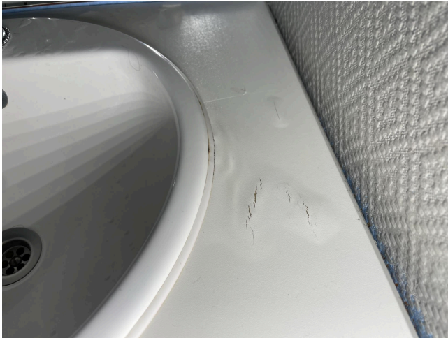
Skade på innredning.
