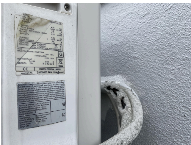
Skade på kondensisolasjonen til rørføringer.
