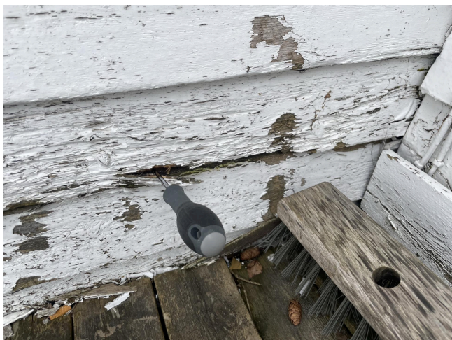
Råteskader på kledning.
