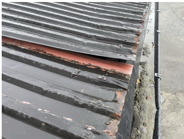
Løs takteking i skjøter.
