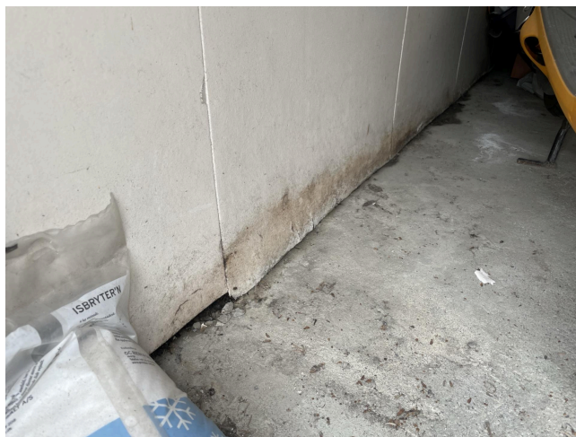
Skader på overflaten.
