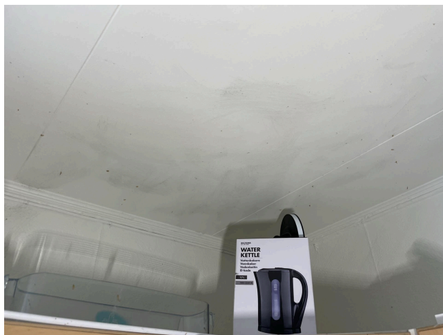
Flekker på overflaten.
