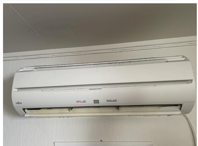
Produktet nærmer seg utløpsdato (forventet levetid: 12–15 år med service).
