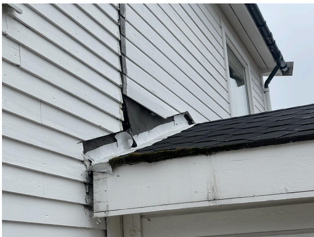
Innfestinger og overganger er ikke tilfredsstillende.
