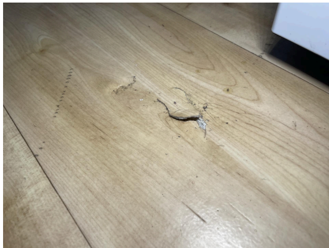
Skader på overflaten. Flekker på overflaten.
