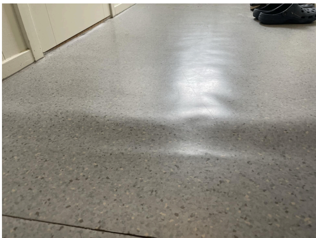
Skader på overflaten.
