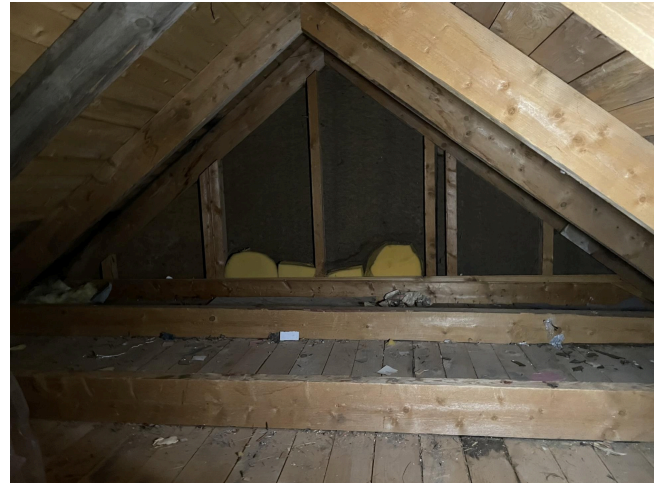
Takkonstruksjonen er ikke isolert. Manglende dampsperrsjikt i himling mellom varmt og kaldt rom.
