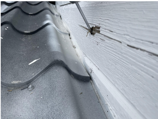
Dårlige eller uegneede løsninger for tilkobling og tetting.
