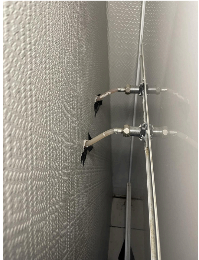
Gjennomføringer i våtsone vegg er ikke korrekt utført.
