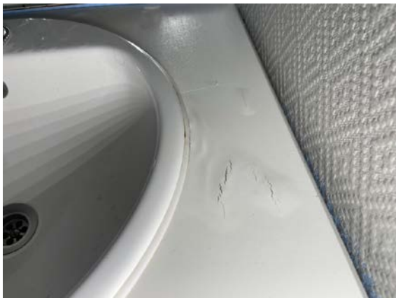
Skade på innredning.
