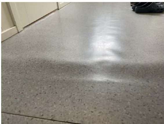
Skader på overflaten.
