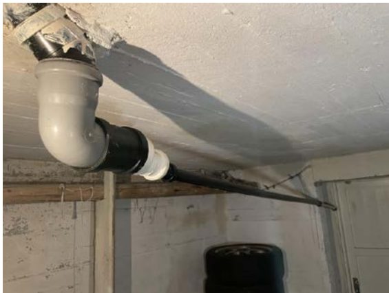
Uisolert avløpsrør i uoppvarmet rom.
