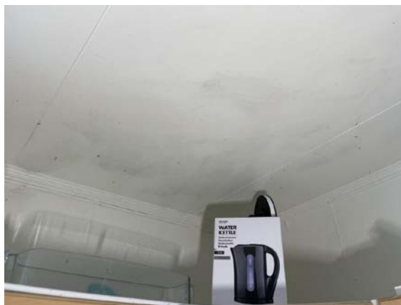
Flekker på overflaten.
