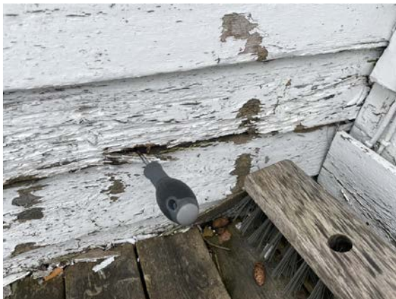
Råteskader på kledning.
