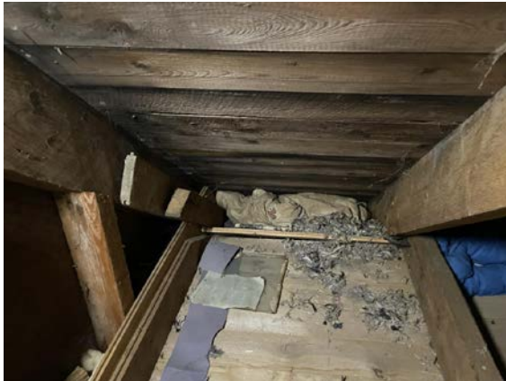
Spor etter oppspist fugl. Ingen ventilering av takkonstruksjonen.
