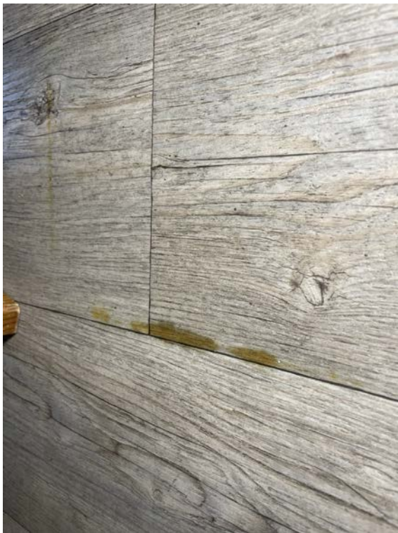
Flekker på overflaten.
