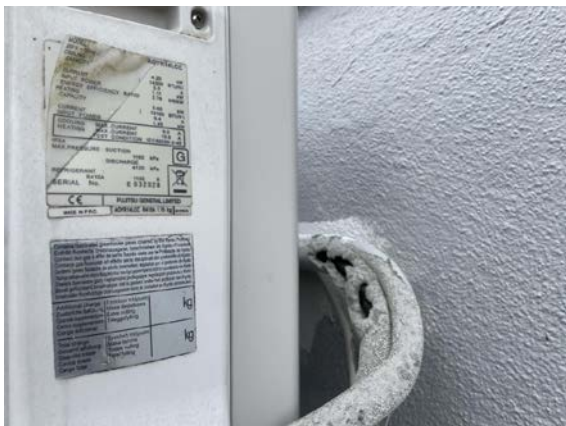
Skade på kondensisasjonen til rørføringer.
