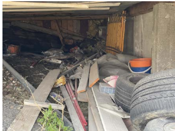
Manglende terrengfall vegg fra bygningen.
