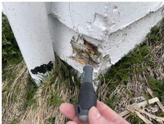
Råteskader på kledning.
