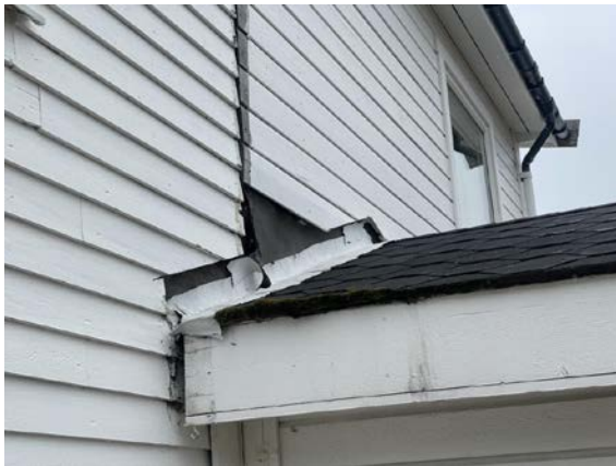
Innfestinger og overganger er ikke tilfredsstillende.
