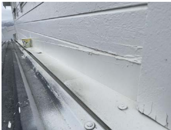
Dårlige eller uegnede løsninger for tilkobling og tetting.
