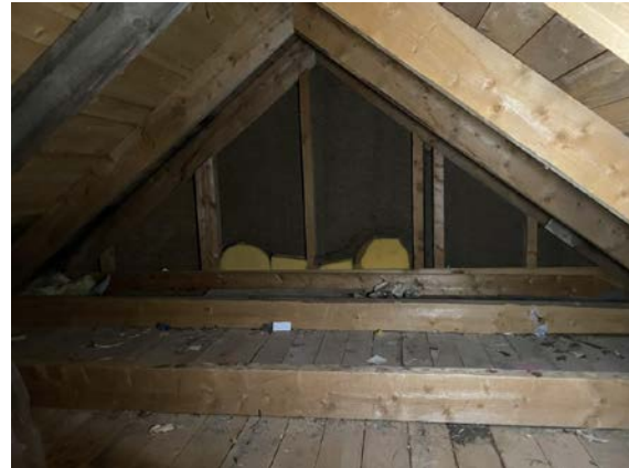
Takkonstruksjonen er ikke isolert. Manglende dampspærresjikt i himling mellom varmt og kaldt rom.
