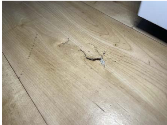
Skader på overflaten. Flekker på overflaten.
