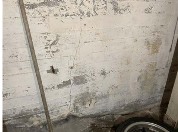
Sprekker på murkonstruksjon innside under garasje.
