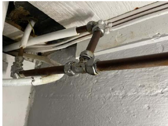
Termisk isolasjon og kondensisolasjon av vannrør i kjeller er ikke tilfredsstillende
