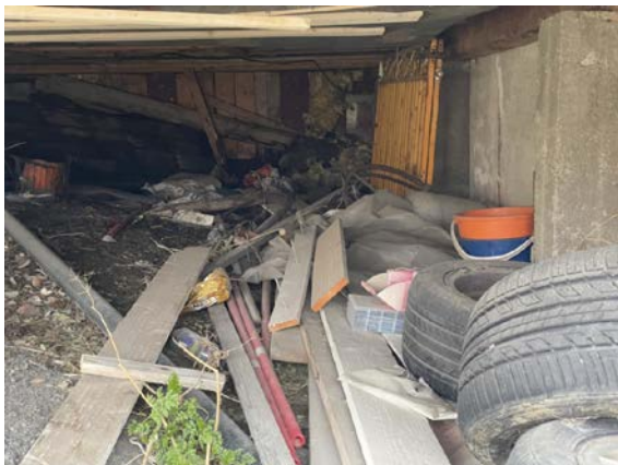
Det er motfall (fall inn mot bygningen). Maksimale forhold for vann inn mot muren.
