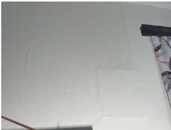
Skader på overflaten.
