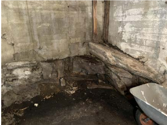
Kapillærtransport av fukt. Måling innside indikerer fukt i nedre del av vegg.
