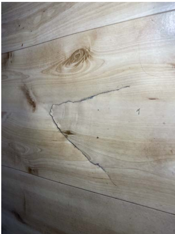
Skader på overflaten.
