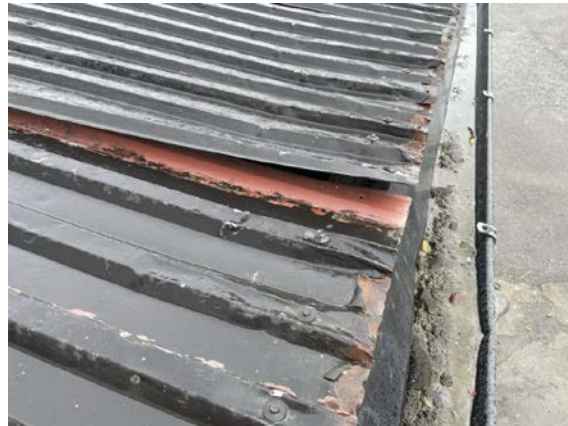
Løs takteking i skjøter.
