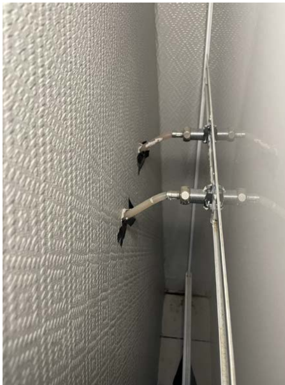
Gjennomføringer i våtsone vegg er ikke korrekt utført.
