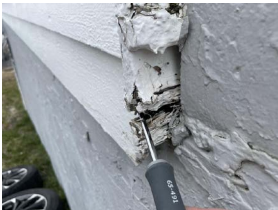
Råteskader på kledning.
