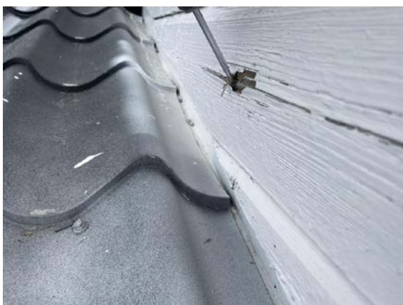
Dårlige eller uegnede løsninger for tilkobling og tetting.
