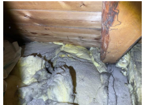
Manglende lufting ut mot skråtak.
