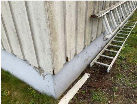
Råte i nedre kant av kledning.
