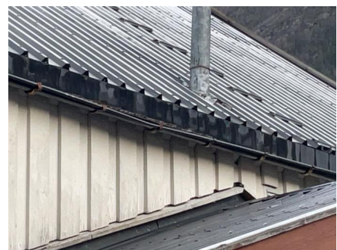
Nedbøyning på takrenner etter takras.
