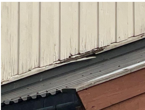
Råte på kledning/vannbrett over inngangsparti.
