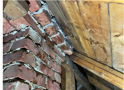
Fuktskjolder rundt pipe.
