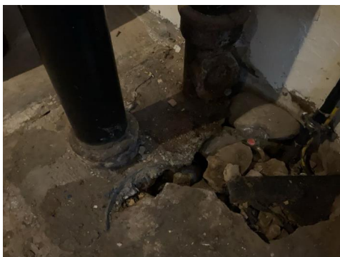
Hull i betonggulv etter ny vannledning. Avløp er i støpejern.
