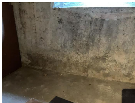
Fukt på yttervegger i kjeller.
