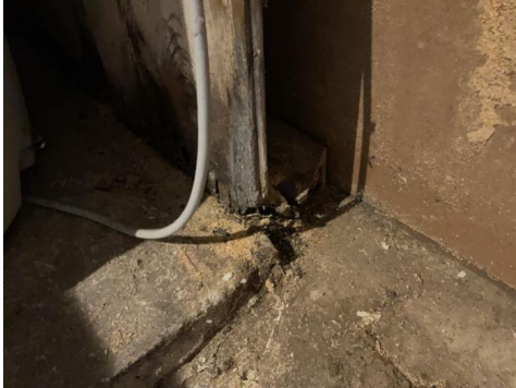
Fukt i treverk i vaskerom.
