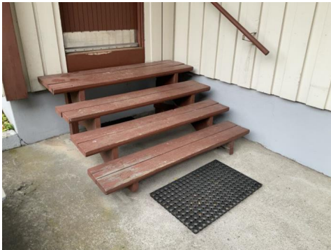
Trapp i tre til inngangsparti uten rekkverk.
