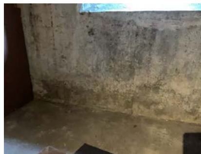
Fukt på yttervegger i kjeller.
