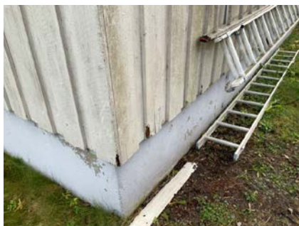
Råte i nedre kant av kledning.
