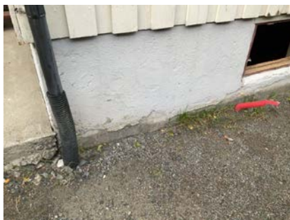
Noe riss/løs/manglende puss.
