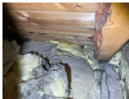
Manglende lufting ut mot skråtak.
