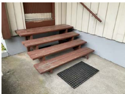
Trapp i tre til inngangsparti uten rekkverk.
