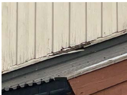
Råte på kledning/vannbrett over inngangsparti.
