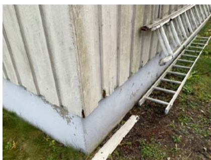
Råte i nedre kant av kledning.
