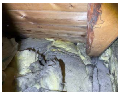
Manglende lufting ut mot skråtak.
