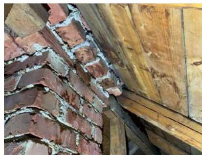
Fuktskjolder rundt pipe.
