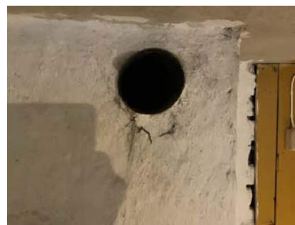
Lufting til pipe.
