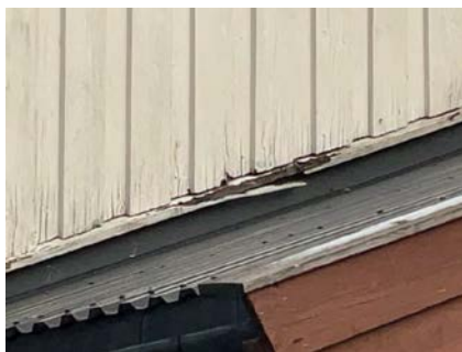
Råte på kledning/vannbrett over inngangsparti.
