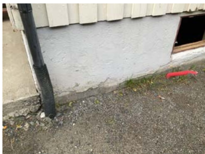
Noe riss/løs/manglende puss.
