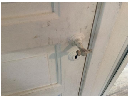
Skadet vrider og dør er grovt malt.
