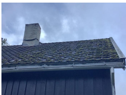
Mosedannelse på taktekking.
