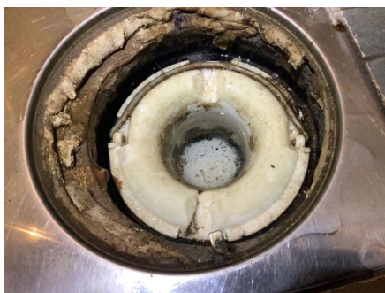
Plastsluk, og synlig slukmansjett under slukets klemring.
