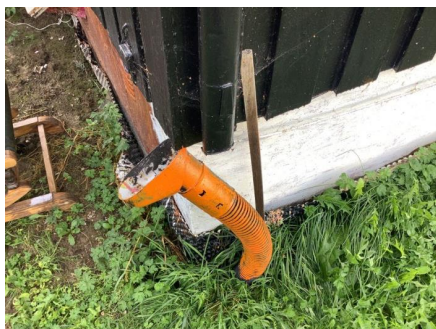
Mangelfull bortledning av takvann.
