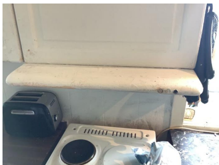
Malt kjøkkenventilator med manglende knapp for betjening.
