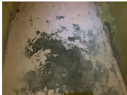
Saltutslag på betonggulv.
