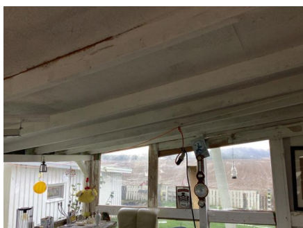
Svank / skjevhet i takkonstruksjonen.
