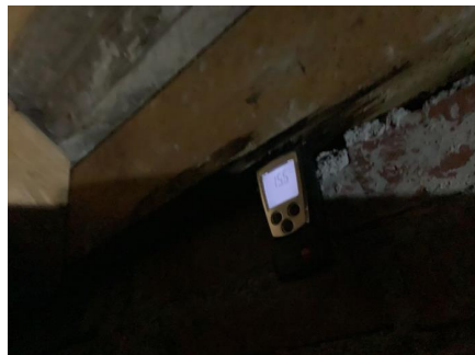
Misfarging rundt pipe, men det måles tørt.
