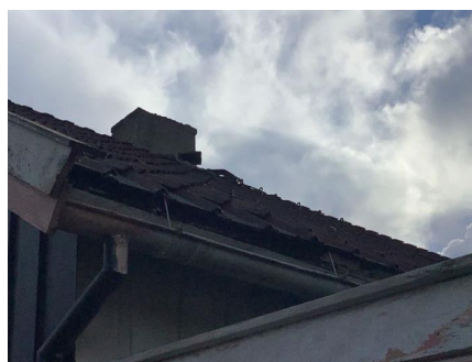
Steinlekt er råteskadet i dette området.
