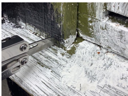
Omramming rundt vinduer er ført helt ned til vannbrett og dette har ført til råteskader. Overmalte råteskader.
