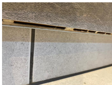
Mangelfull fuge mellom platebunn og sokkellist.
