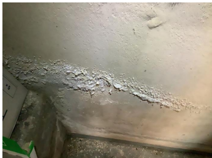
Saltutslag på murvegg.
