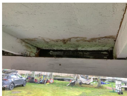
Fuktskadet fremkant av takkonstruksjon.
