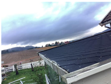
Taktekking er ikke ført over forkantbord.
