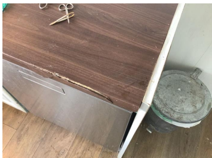
Skadet benkeplate og svellskadet dekkside.
