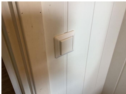
Sidestilt lysbryter og det er lite trolig at fagperson har montert denne.
