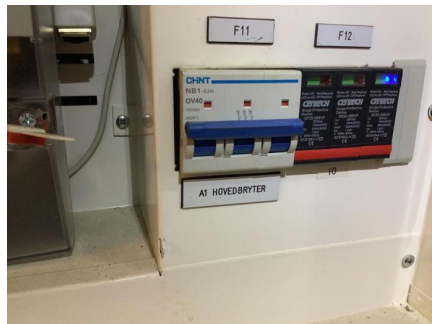
To av tre overspenningsvern er defekte.
