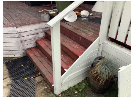
Åpninger i rekkverk er ikke iht. gjeldende forskrift.
