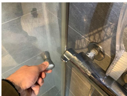
Dusjdør tar i dusjbatteri.
