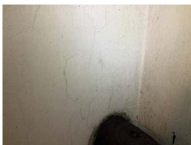
Eksempel på riss i pipe.
