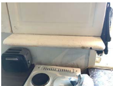
Malt kjøkkenventilator med manglende knapp for betjening.
