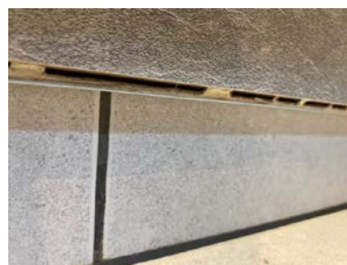
Mangelfull fuge mellom platebunn og sokkellist.
