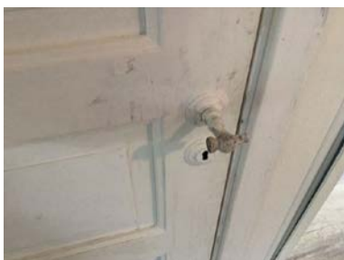
Skadet vrider og dør er grovt malt.
