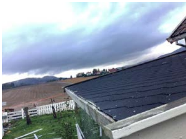
Taktekking er ikke ført over forkantbord.
