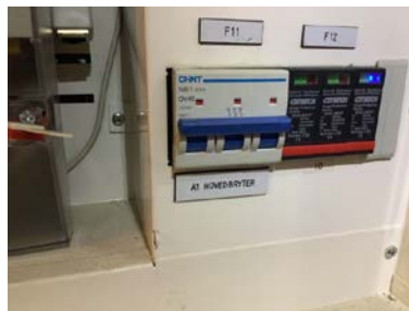
To av tre overspenningsvern er defekte.
