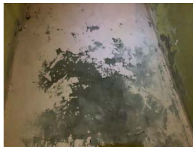
Saltutslag på betonggulv.
