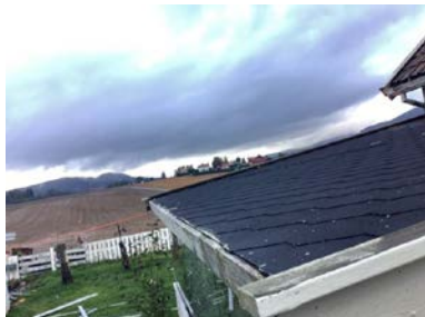
Taktekking er ikke ført over forkantbord.
