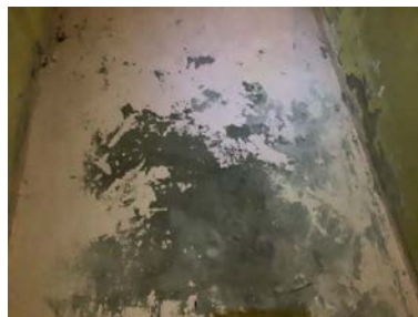
Saltutslag på betonggulv.
