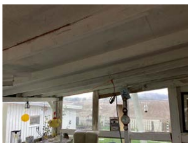
Svank / skjevhet i takkonstruksjonen.
