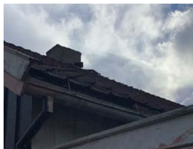
Steinlekt er råteskadet i dette området.
