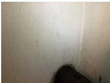
Eksempel på riss i pipe.
