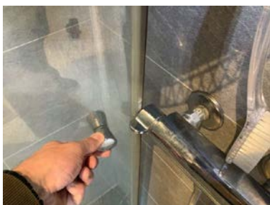
Dusjdør tar i dusjbatteri.
