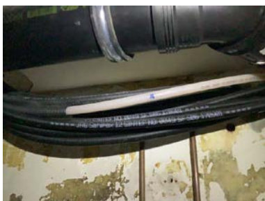
Evt. lekkasjevann fra varerør ledes ikke til sluk.
