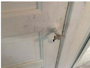
Skadet vrider og dør er grovt malt.
