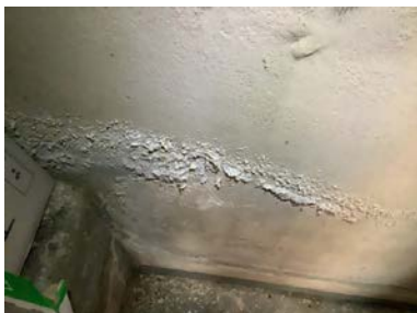
Saltutslag på murvegg.
