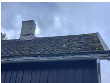
Mosedannelse på taktekking.
