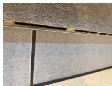
Mangelfull fuge mellom platebunn og sokkellist.
