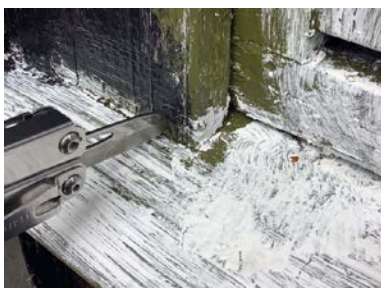
Omramming rundt vinduer er ført helt ned til vannbrett og dette har ført til råteskader.
