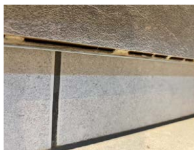
Mangelfull fuge mellom platebunn og sokkellist.
