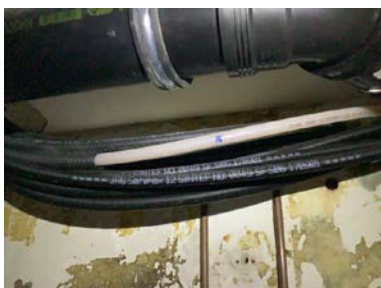
Evt. lekkasjevann fra varerør ledes ikke til sluk.
