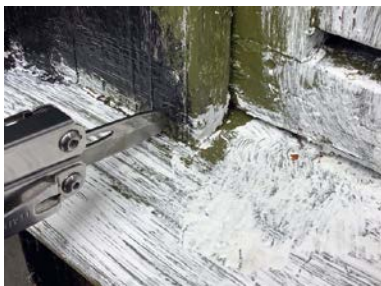
Omramming rundt vinduer er ført helt ned til vannbrett og dette har ført til råteskader.
