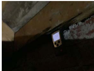
Misfarging rundt pipe, men det måles tørt.
