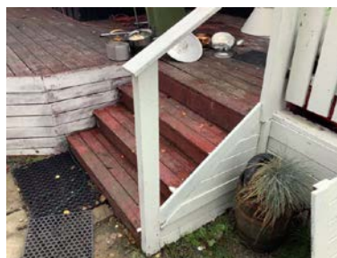
Åpninger i rekkverk er ikke iht. gjeldende forskrift.
