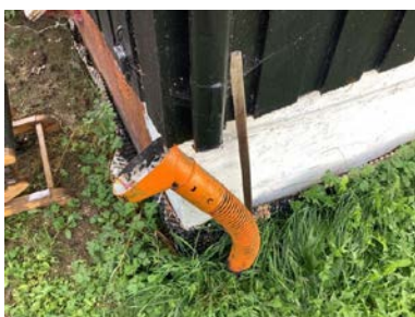
Mangelfull bortledning av takvann.
