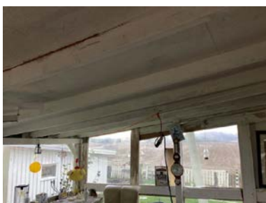
Svank / skjevhet i takkonstruksjonen.
