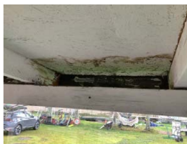
Fuktskadet fremkant av takkonstruksjon.
