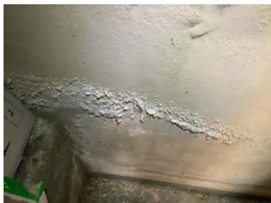
Saltutslag på murvegg.
