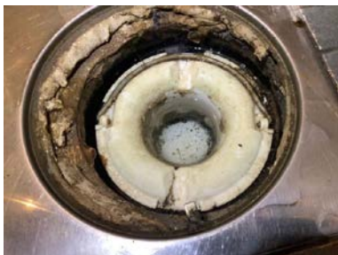
Plastsluk, og synlig slukmansjett under slukets klemring.
