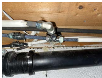
Drypp fra rørskjøt
