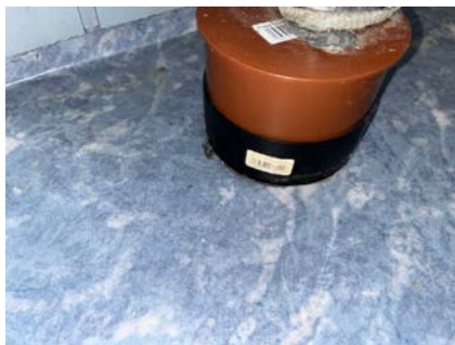
Sprekk i belegg.
