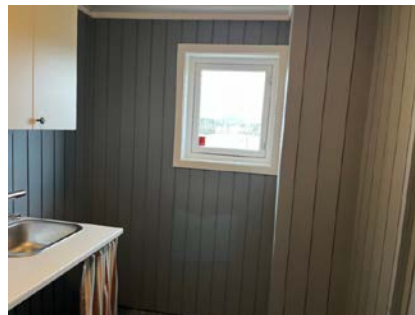
Manglende tettesjikt på vegger.
