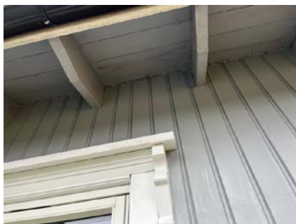
Ingen lufteskalte ved raft.
