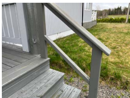
Lavt rekkverk, store åpninger.
