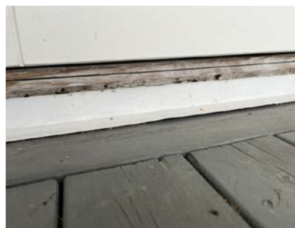
Dårlig tetting under ytterdør.
