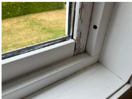
Fukt/råteskade i vindu loftetasje
