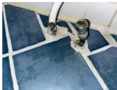
Synlig hull ved rørgjennomføring
