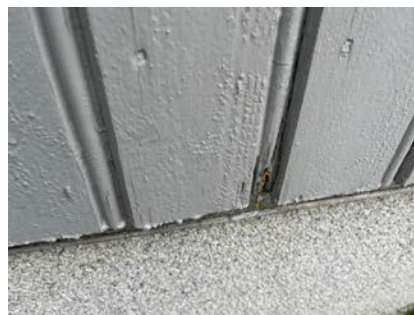
Spredte råteskader i kledning.
