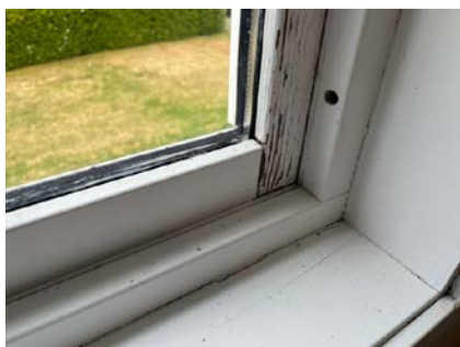
Fukt/råteskade i vindu loftetasje
