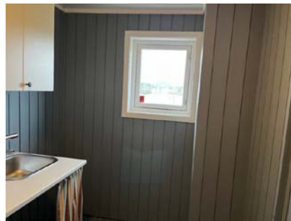
Manglende tettesjikt på vegger.
