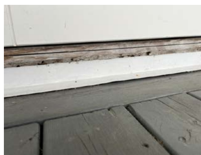
Dårlig tetting under ytterdør.
