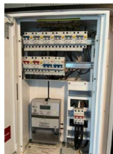
Manglende kapsling i sikringsskap
