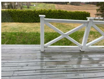
Store åpninger i rekkverk
