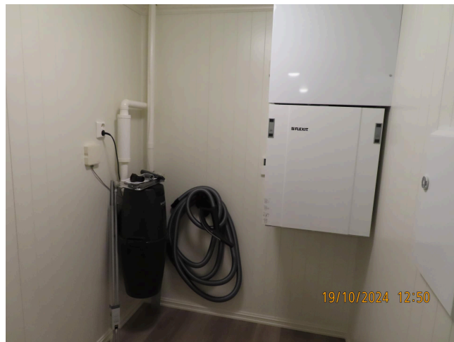
Sentralstøvsuger og ventilasjonsaggregat i teknisk rom
