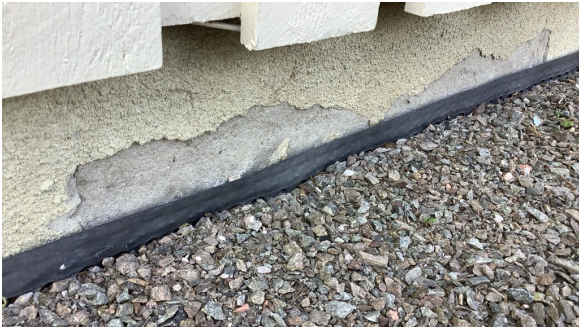
Område med manglende puss.
