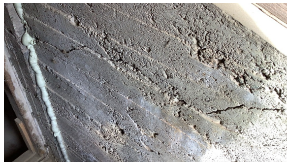
Sprekkdannelse i støpt vange.
