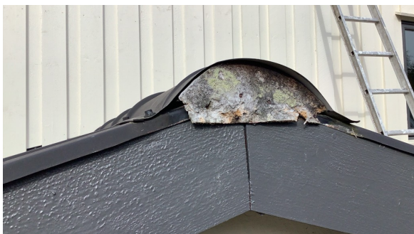
Endelokk av fuktskadet treverk.
