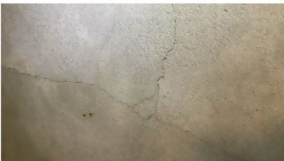
Innvendig skrå- og horisontalriss.
