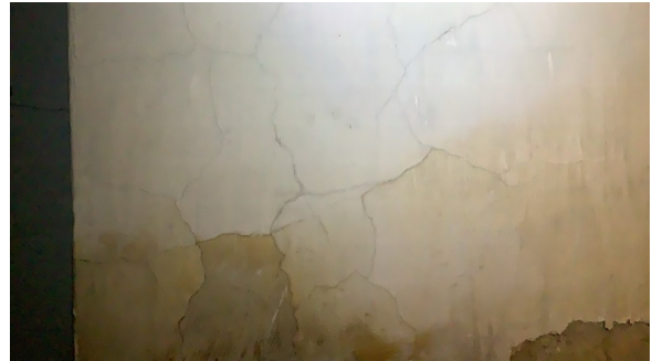
Riss i pipe i kjeller.
