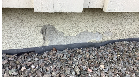
Skråriss og område med manglende puss.
