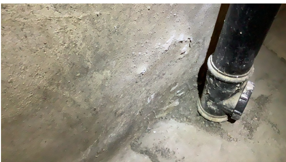
Saltutslag på grunnmur.
