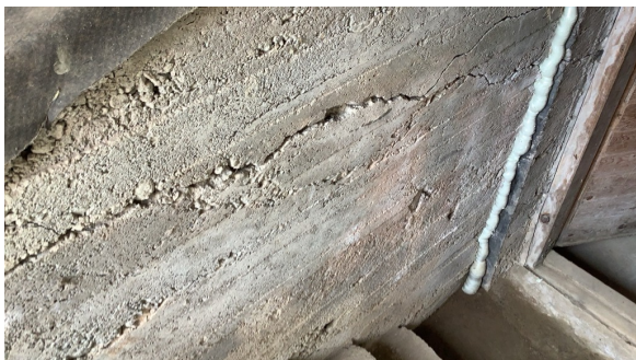
Sprekkdannelse i støpt vange.
