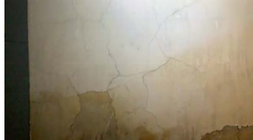
Riss i pipe i kjeller.
