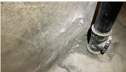
Saltutslag på grunnmur.
