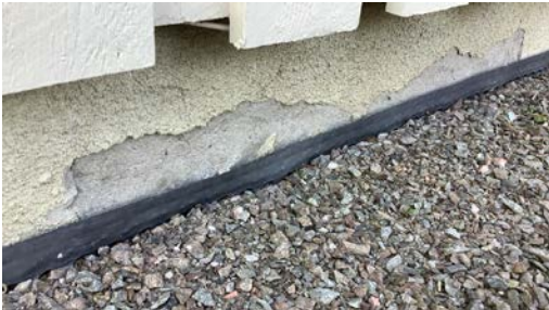
Område med manglende puss.
