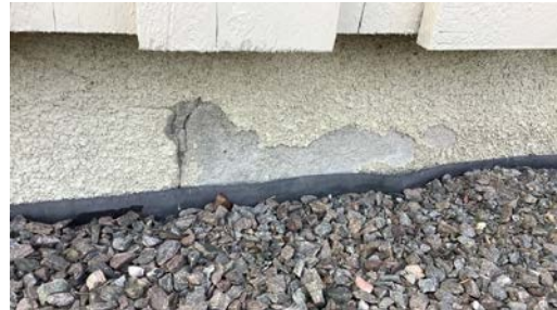
Skråriss og område med manglende puss.
