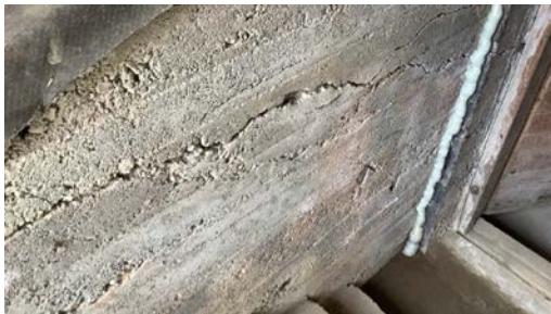
Sprekkdannelse i støpt vange.
