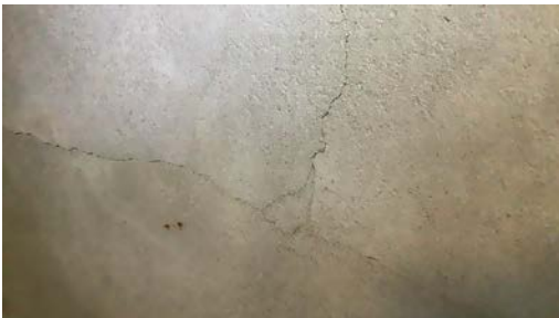
Innvendig skrå- og horisontalriss.
