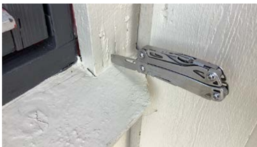
Omramming er ført helt ned til vannbrett og dette har ført til råteskader.
