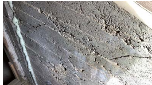
Sprekkdannelse i støpt vange.
