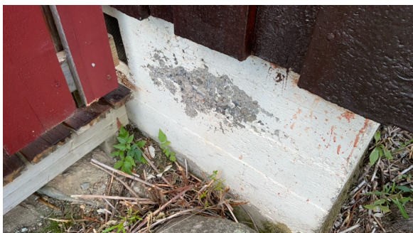
Forvitret grunnmur enkelte steder.
