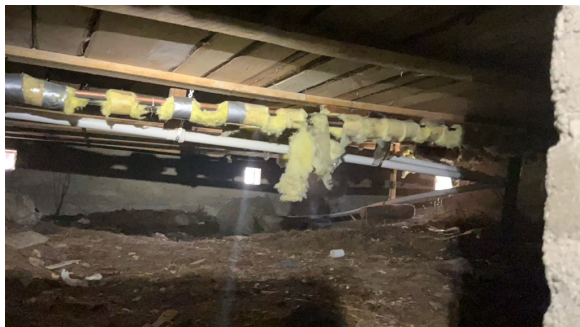
Manglende isolasjon rundt rør i krypkjeller.
