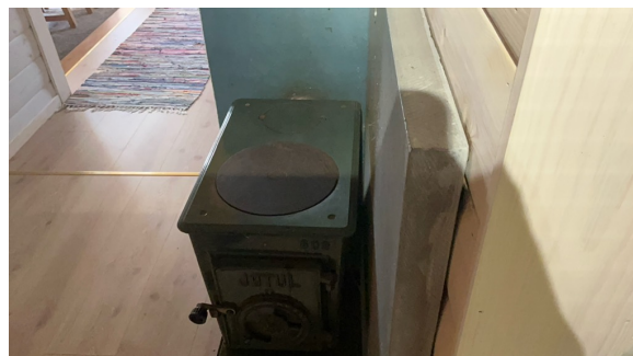
Kort avstand mellom ildsted og brannmur.
