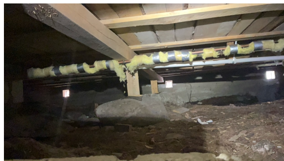
Synlige skjevheter/svai i bjelke krypkjeller. Forenklet fundamentering.
