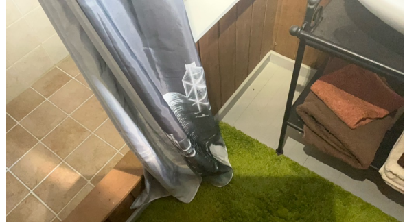
Manglende membran registrert på gulv og vegg utenfor dusj. Dette er definert som våtsoner.
