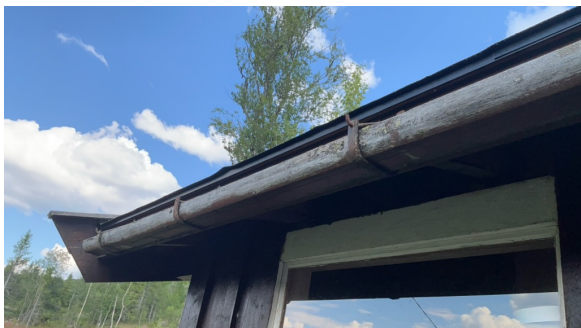
Takrenne i tre på tilbygd bod bærer preg av slitasje.
