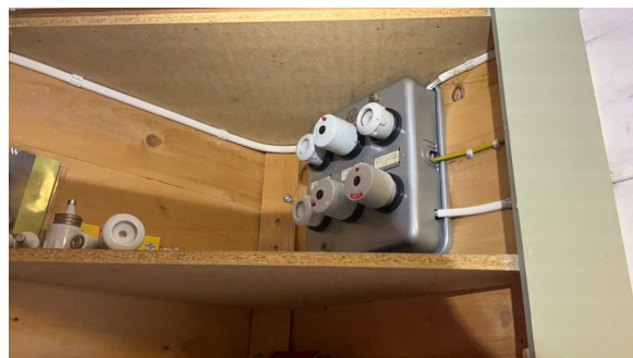
Sikringer i overskap kjøkken.
