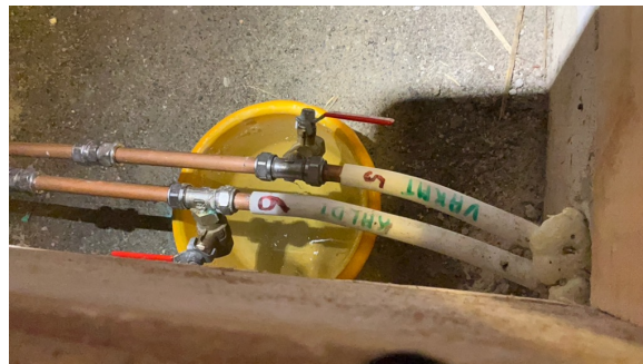
Mindre drypplekkasje i vannrør i luke under kjøkken. Forholdet gis tilstandsgrad 3.
