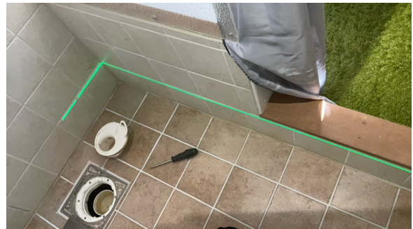
Flislagt dusjnise med oppkant, begrenser fuktpåkjenningen på resterende våtrom med uegnede materialer og manglende membran.
