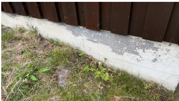
Malingsflass på grunnmur.
