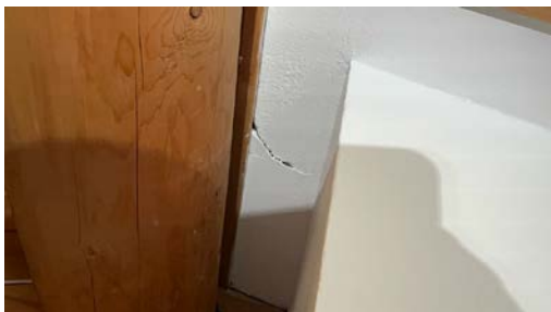
Sprekk i krage på pipe.
