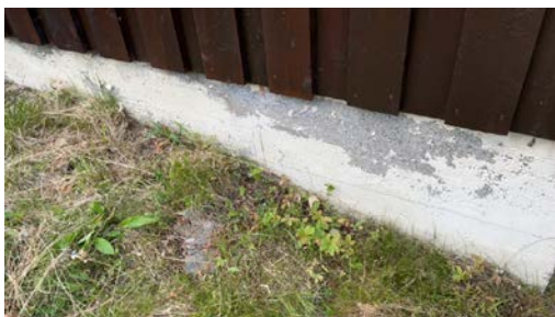
Malingsflass på grunnmur.
