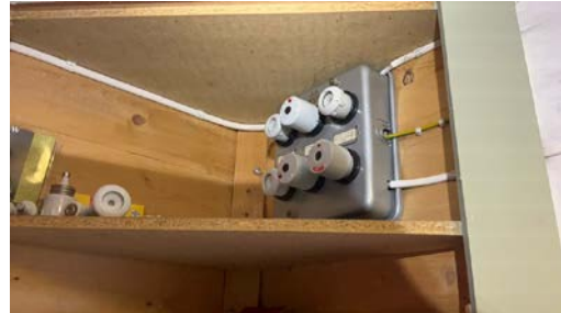
Sikringer i overskap kjøkken.
