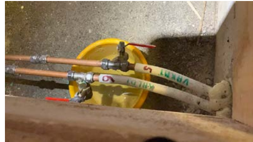
Mindre drypplekkasje i vannrør i luke under kjøkken. Forholdet gis tilstandsgrad 3.
