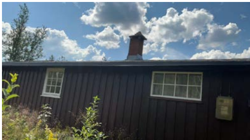
Skjevheter/svai på takflate.
