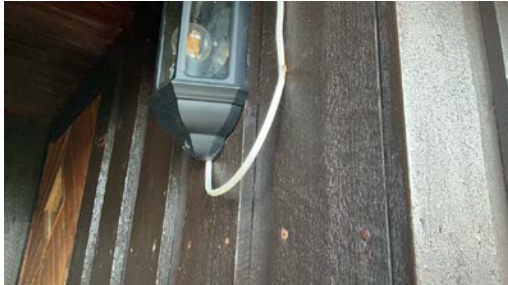
Løs ledning registrert.
