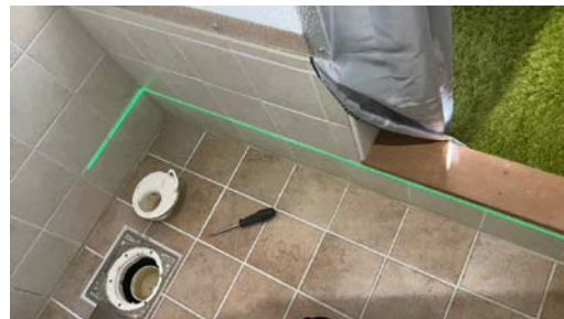
Flislagt dusjnise med oppkant, begrenser fuktpåkjenningen på resterende våtrom med uegnede materialer og manglende membran.
