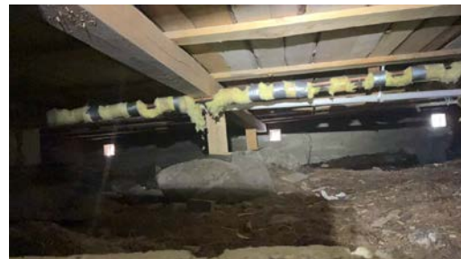
Synlige skjevheter/svai i bjelke krypkjeller. Forenklet fundamentering.
