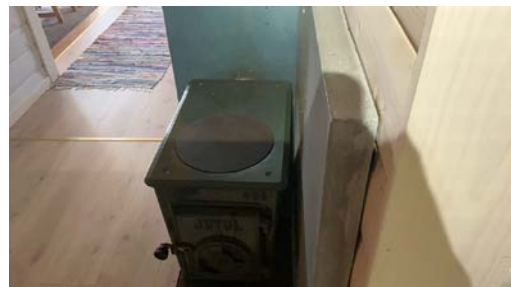
Kort avstand mellom ildsted og brannmur.
