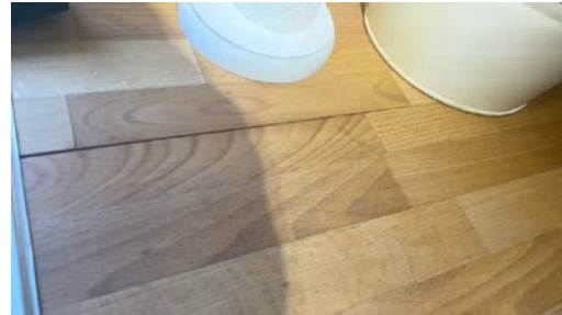
Sprekk i benkeplate.
