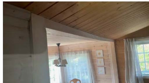
Skjevheter i himling/drager overgang til utbygg i stue. Selger opplyser at dette har vært slik lenge.
