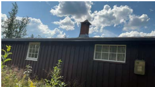
Skjevheter/svai på takflate.
