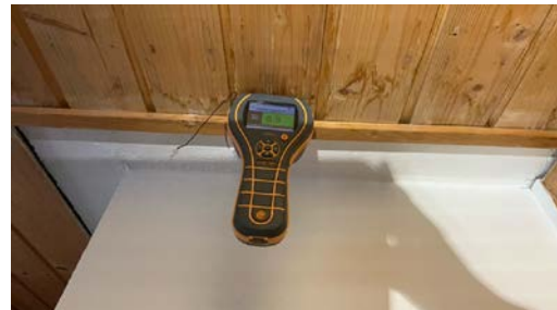
Fuktmerker i himling rundt pipe. Fuktmåling viste tørre verdier.
