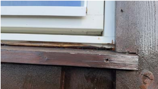
Utett mellom vannbrett og vindu. Dette øker risikoen for fuktinntrengning.
