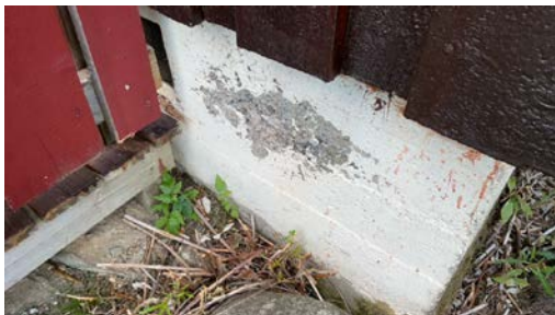
Forvitret grunnmur enkelte steder.
