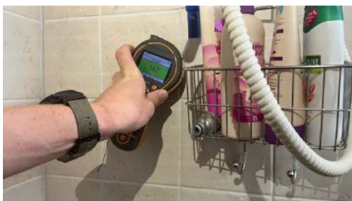
Enkle fuktsøk viste normale verdier.
