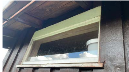
Eldre vindu i inntilliggende bod bærer preg av slitasje.
