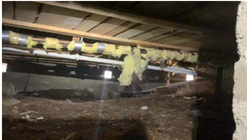
Manglende isolasjon rundt rør i krypkjeller.
