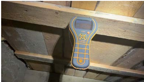
Fuktmålinger i etasjeskiller viste skadelige verdier for fukt.
