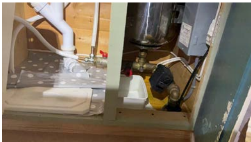
Stoppekran og trykktank i benkeskap kjøkken.
