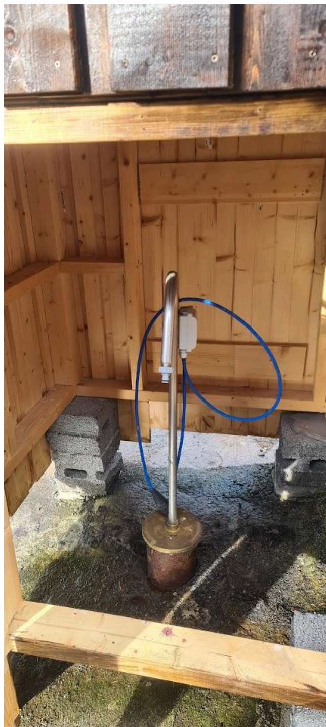
Innendig i bygning over bergborebrønn.
