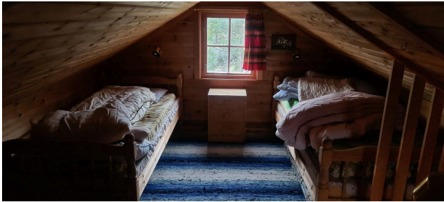
Hems med 2 soveplasser, vindu er ikke godkjent for rømning.
