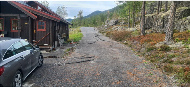
Adomstveg på siden av hytta, hvor veg har vannskader.
