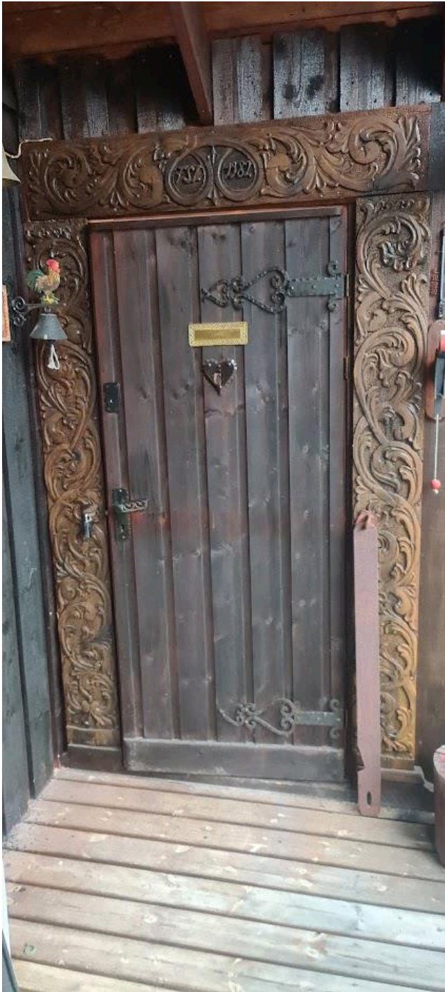
Ytterdør tar i dørterskel.
