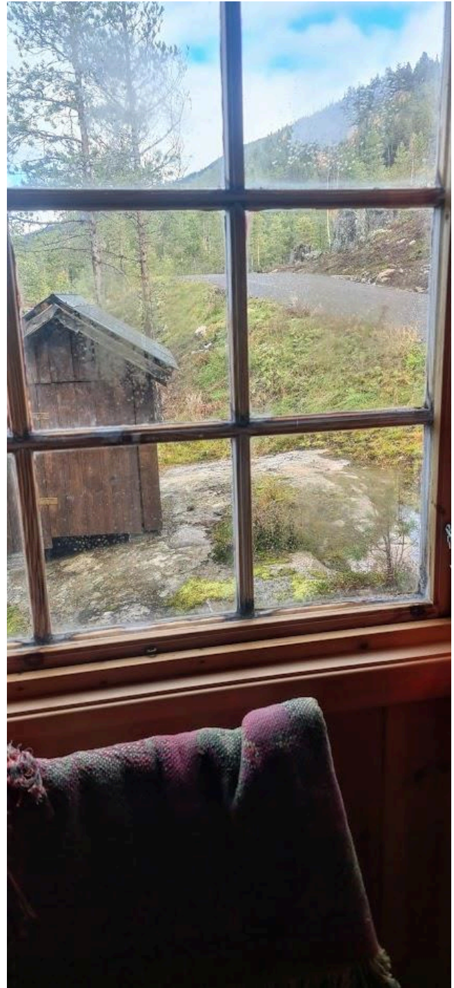
Kondensskader mellom inner og ytterrammer.
