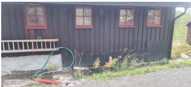
El.kabel er gravd fra til grunnmur under gang i hytta. Metallplater montert som beskyttelse i bunn kledning?
