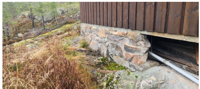
Steinmur med betongmørtel mellom som bæring for hytta opp på fjell. Støpt betongdrager med dimensjon HxbxL=80x90x1900mm.
