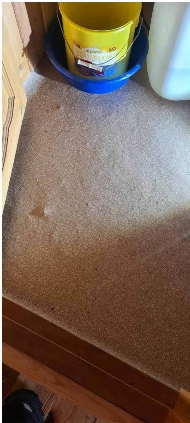
Ujevnheter i overflate Terrazzo.
