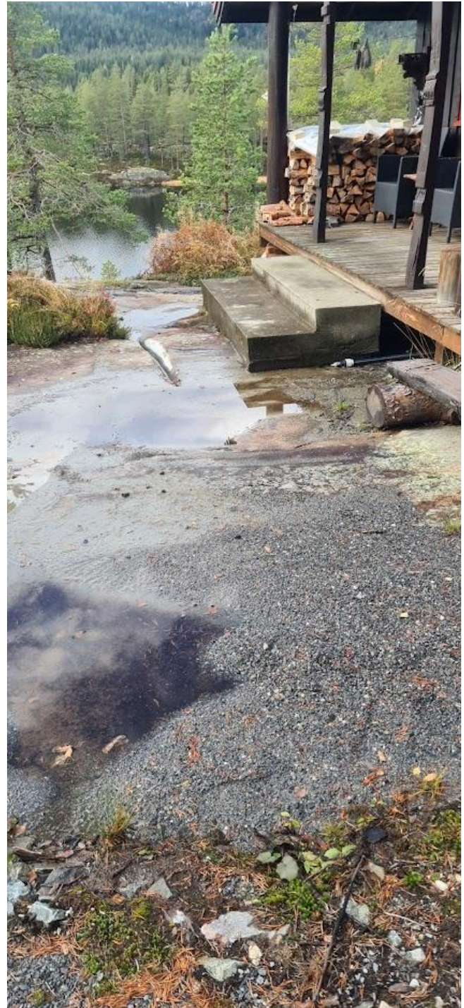
Vanndam på fjell forna inngang som ikke blir drenert vekk.
