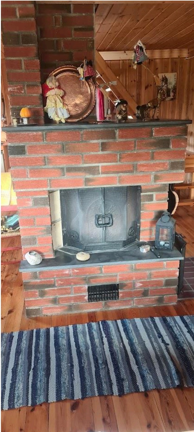
Peis med innsats i stue, se manglende beskyttelse på gulv foran peis.
