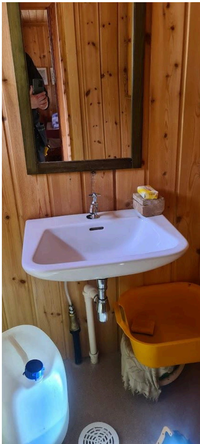
Servant med kaldt vanns kran.
