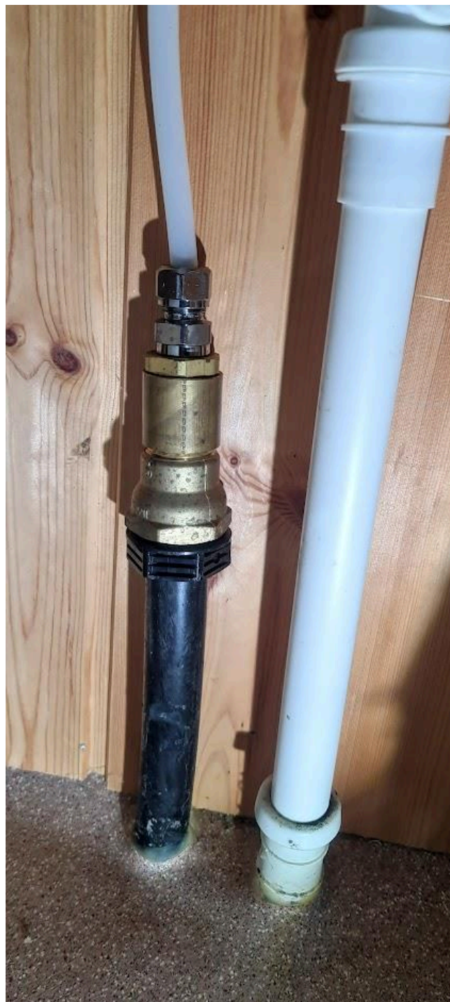
Vann og avløpsledning gjennom Terrazzo uten rørmansjett.
