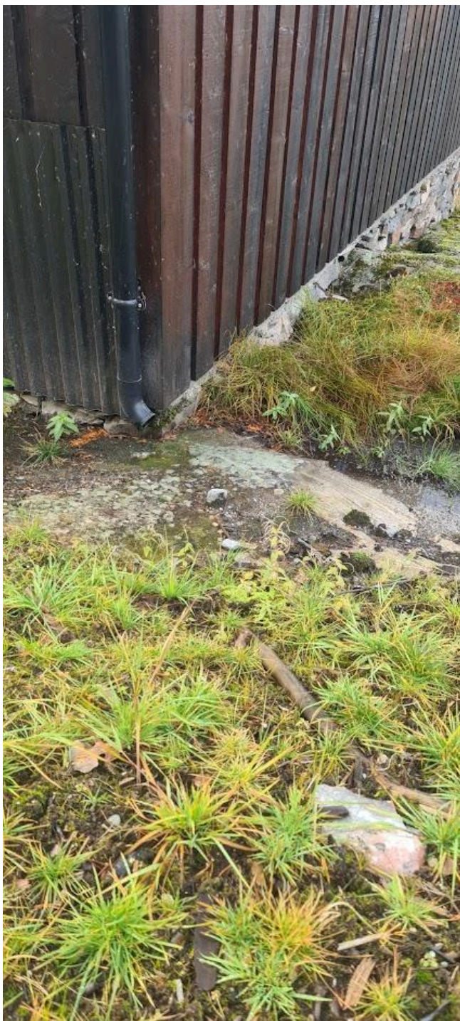
Takrennedløp hvor vann ikke er ledet vekk fra grunnmur.
