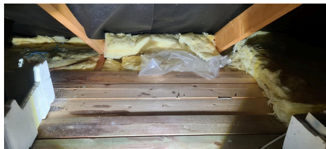
Synlig imregnert forhudningspapp hvor isolasjon er presset opp mot taktro.
