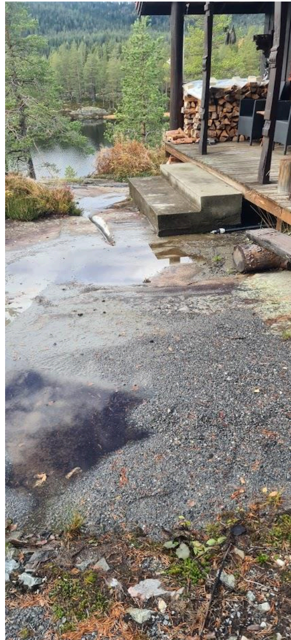
Vanddam på fjell forna inngang som ikke blir drenert vekk.
