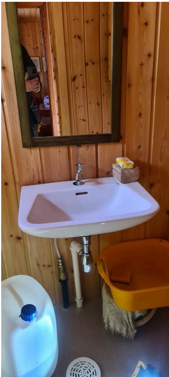
Servant med kaldt vanns kran.
