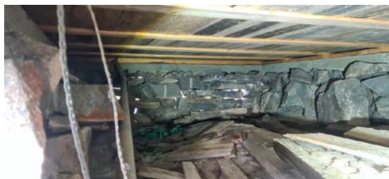
Grunnmur er glissen/åpen mot bygg for bergbrønn.
