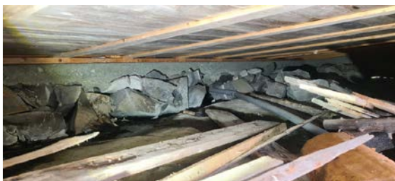
Bilde er tatt i fra åpning på langvegg; lagring av materialer og utstyr, vann og is er synlig i lommer på fjellet samt avløp fra vaskerom.
