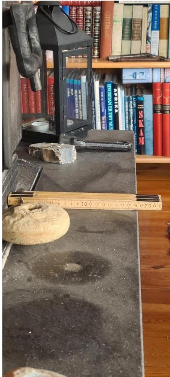
Jøtul 602N står på Skiferplate, men mangler beskyttelse under sot/feieluke på gulv.
