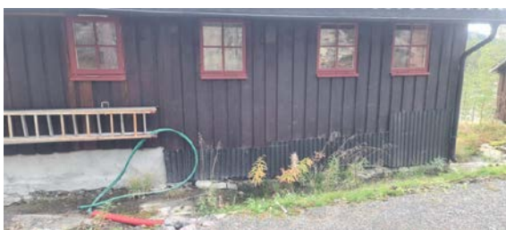
El.kabel er gravd fra til grunnmur under gang i hytta. Metallplater montert som beskyttelse i bunn kledning?
