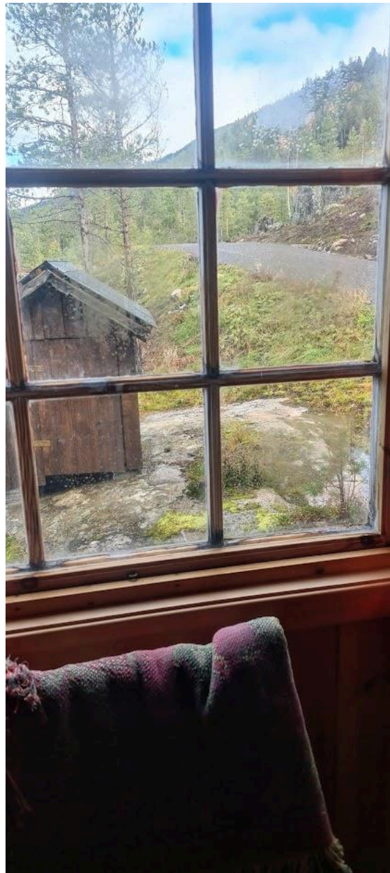
Kondensskader mellom inner og ytterrammer.
