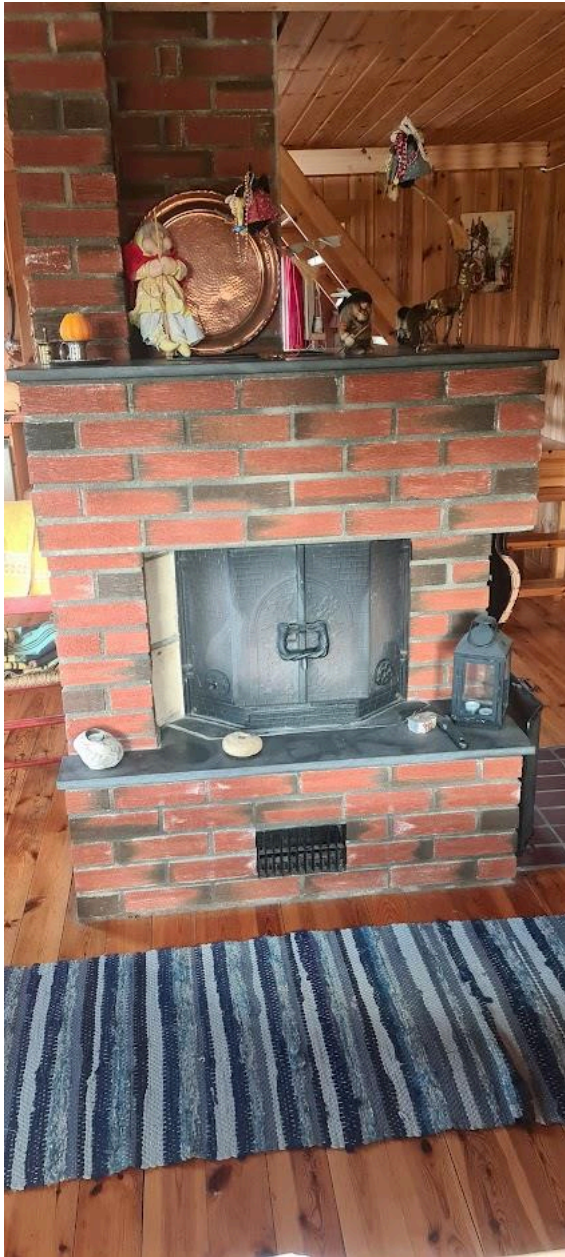
Peis med innsats i stue, se manglende beskyttelse på gulv foran peis.
