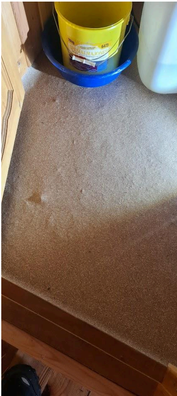
Ujevnheter i overflate Terrazzo.
