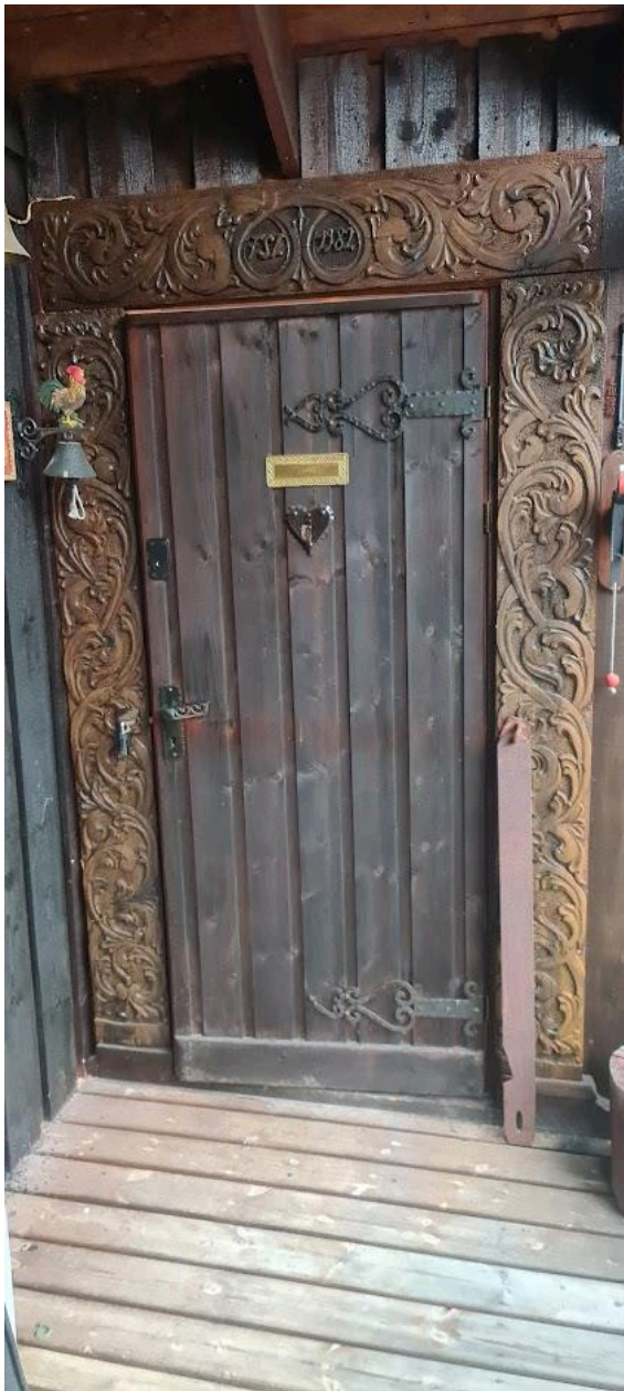
Ytterdør tar i dørterskel.
