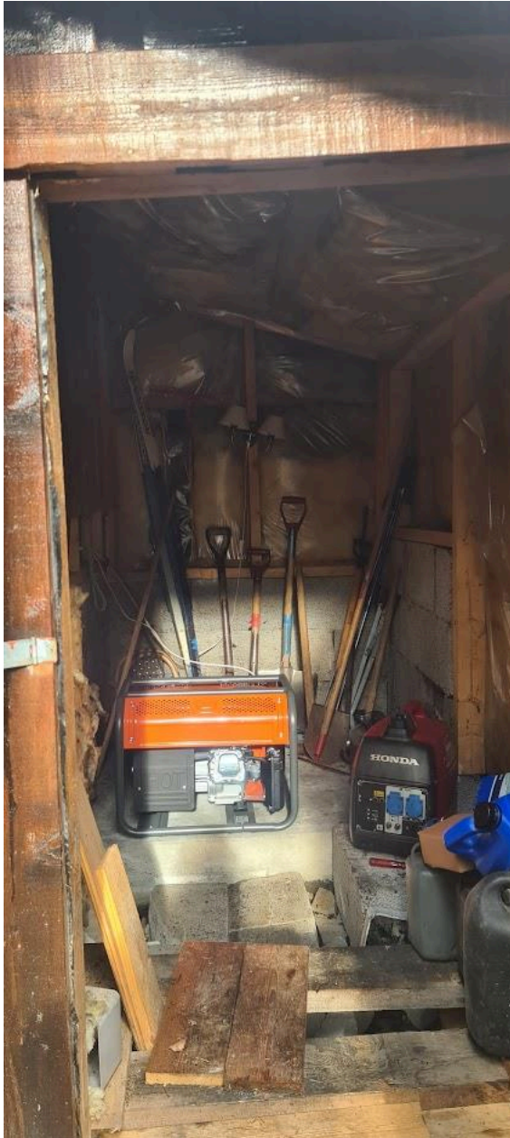
Rom hvor strømagregat er plassert.
