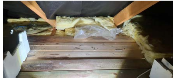
Synlig imregnet forhudningspapp hvor isolasjon er presset opp mot taktro.
