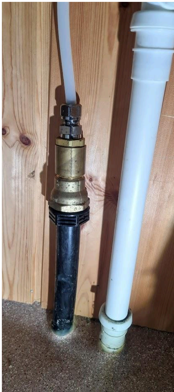
Vann og avløpsledning gjennom Terrazzo uten rørmansjett.
