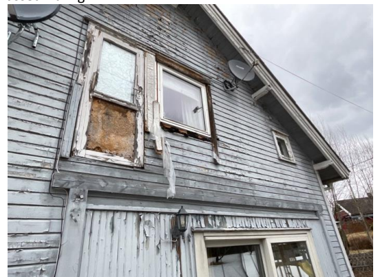
Mangelfull omramming beslag (terrassedøren er blendet innefra)
