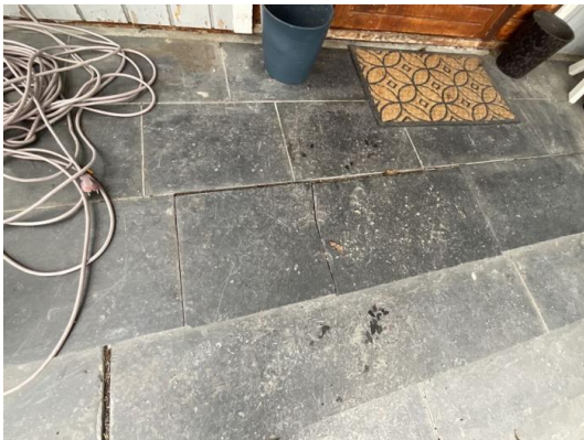
Løse/sprukne flis hovedentre.
