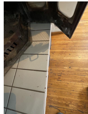
Sprekk flis, ikke ubrennbar plate på gulv
