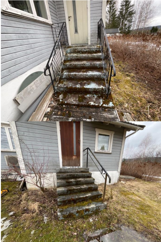
Kun rekkverk en side
