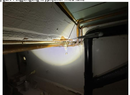
Litt råte i nedkant bjelke ved luke
