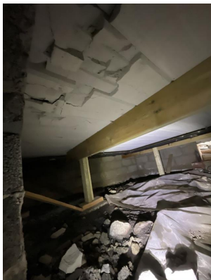
Dekket er forsøkt utbedret m/understøtting av trebjelker
