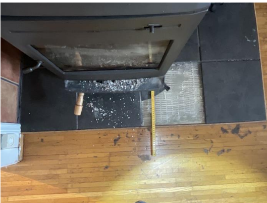
Kort utstikk av flisfelt foran vedinnlegg og flis løsnet/mangler
