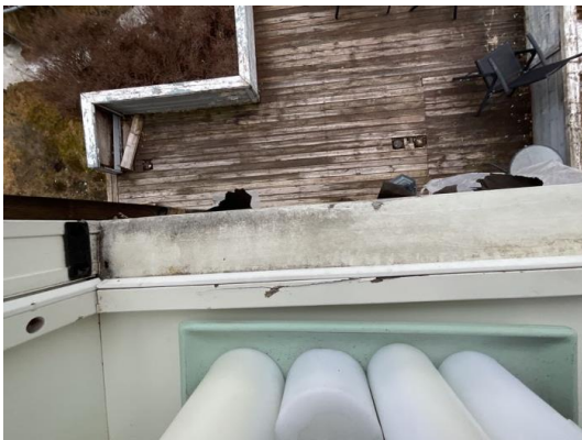
Sprekk karm soveromsvindu
