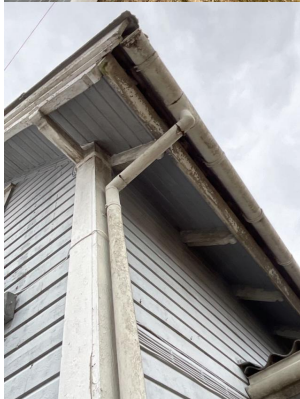
Symptom på punktlekkasjer i skjøter etc.
