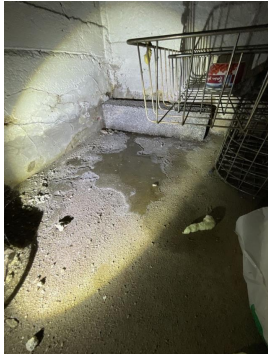
Fuktig miljø/gulv- fritt eksponert vann påvist
