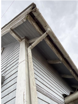
Symptom på punktlekkasjer i skjøter etc.
