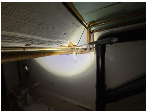
Litt råte i nedkant bjelke ved luke
