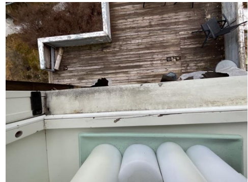
Sprekk karm soveromsvindu
