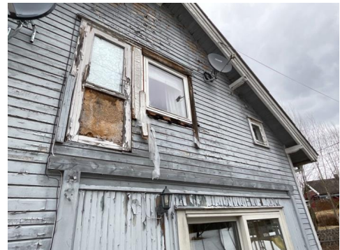
Mangelfull omramming beslag (terrassedøren er blendet innefra)
