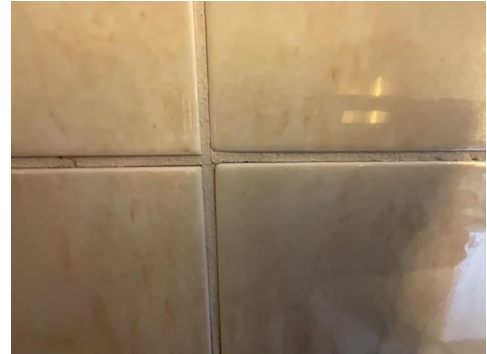
Sprekker flisfuger dusjhjørne
