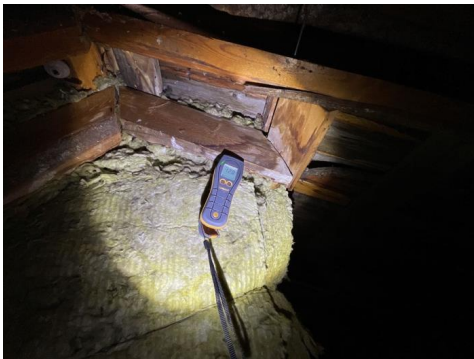
Skjolve ved pipegjennomføring.
