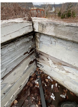
Råteskadet meget lavt rekkverk
