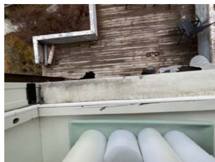
Sprekk karm soveromsvindu
