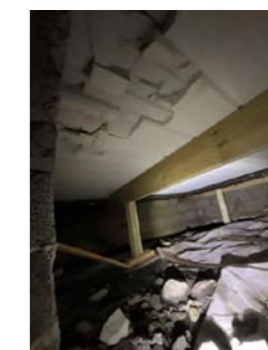
Dekket er forsøkt utbedret m/understøtting av trebjelker
