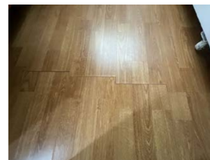
Ufagmessig laminatskjøter (ikke forskjøvet tilstrekkelig)
