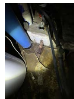
Fuktig gulv i tilgjengelig krypkjeller med luke
