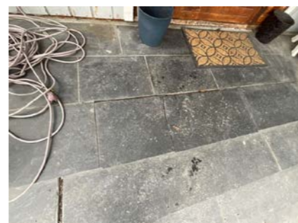
Løse/sprukne flis hovedentre.
