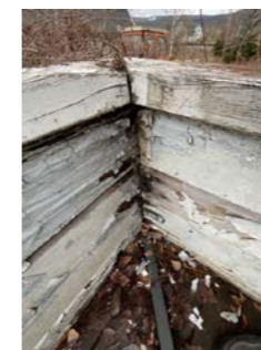
Råteskadet meget lavt rekkverk
