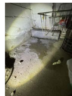
Fuktig miljø/gulv- fritt eksponert vann påvist
