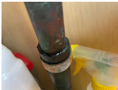
Svette/drypper fra rørskjøt
