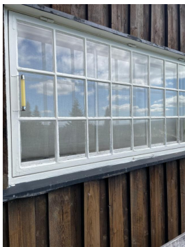
Eksempel på værslitt/sprekker i trevirket utvendig.
