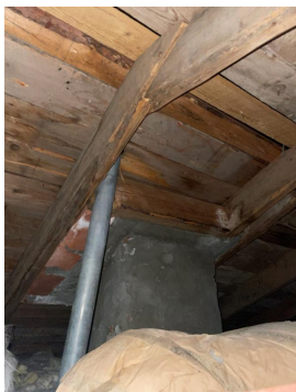
Fuktmerker i treverk ved pipegjennomføring.
