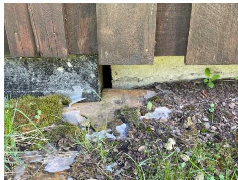
Sprekk mellom tilbygg og eksisterende grunnmur.
