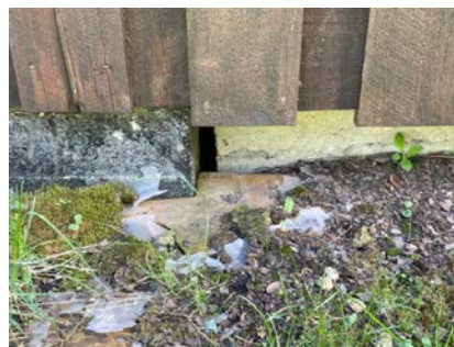
Sprekk mellom tilbygg og eksisterende grunnmur.
