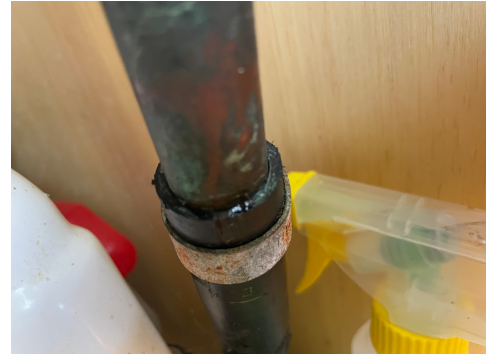
Svette/drypper fra rørskjøt
