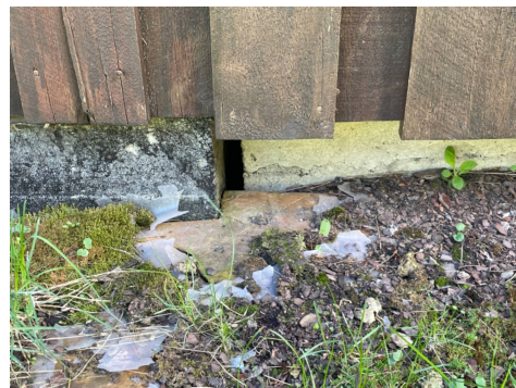
Sprekk mellom tilbygg og eksisterende grunnmur.
