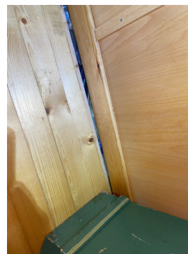
Glipper mellom gulv og gulvlist
