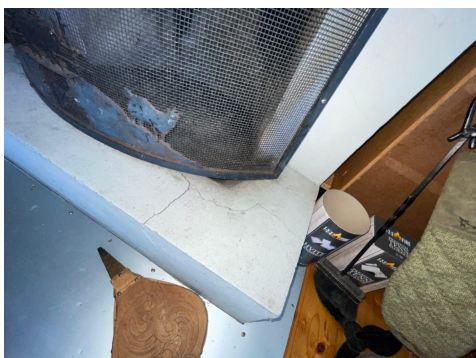
Sprekker i brannmur
