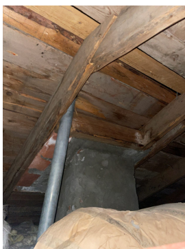
Fuktmerker i treverk ved pipegjennomføring.
