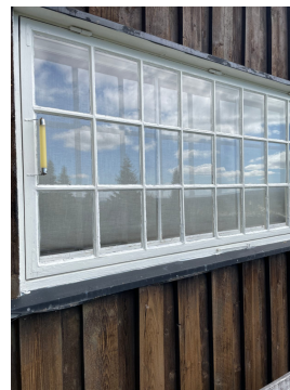
Eksempel på værslett/sprekker i trevirket utvendig og løs overflatebehandling på beslag.
