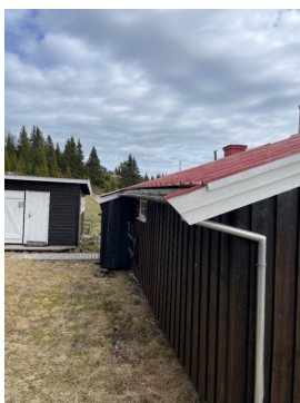
Synlig skeivheter i takkonstruksjon.
