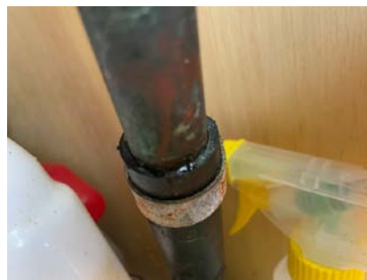
Svette/drypper fra rørskjøt
