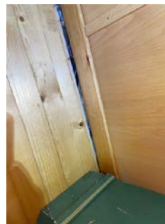
Glipper mellom gulv og gulvlist
