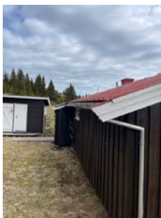
Synlig skeivheter i takkonstruksjon.
