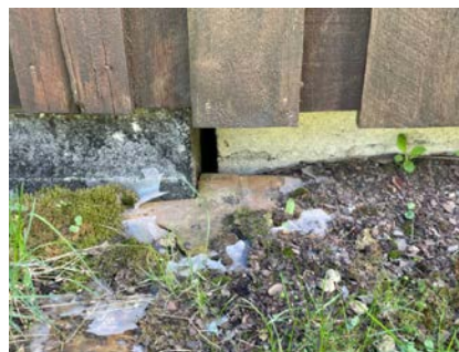
Sprekk mellom tilbygg og eksisterende grunnmur.
