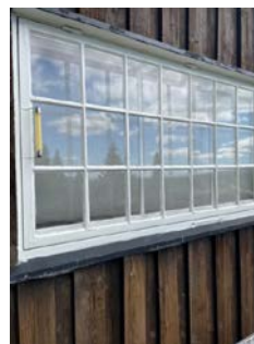
Eksempel på værslitt/sprekker i trevirket utvendig og løs overflatebehandling på beslag.
