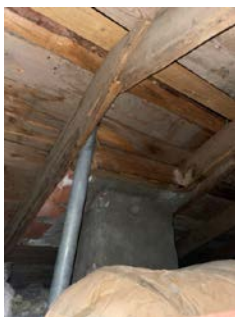
Fuktmerker i treverk ved pipegjennomføring.
