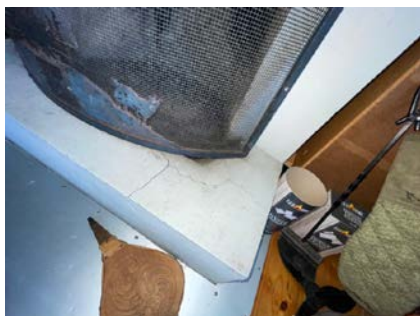
Sprekker i brannmur
