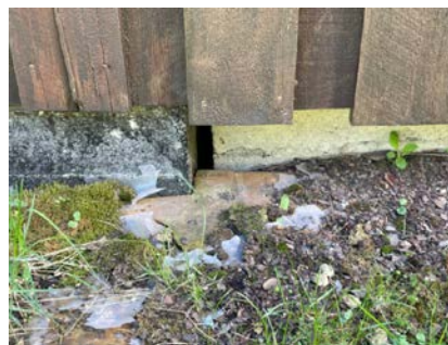
Sprekk mellom tilbygg og eksisterende grunnmur.
