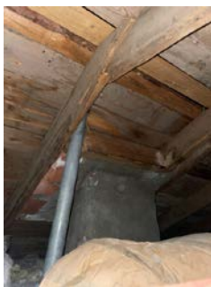
Fuktmerker i treverk ved pipegjennomføring.
