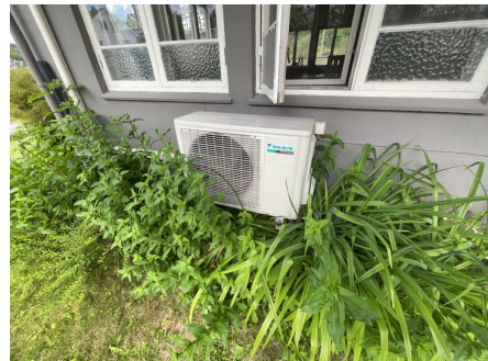
Varmepumpe utvendig komponent.
