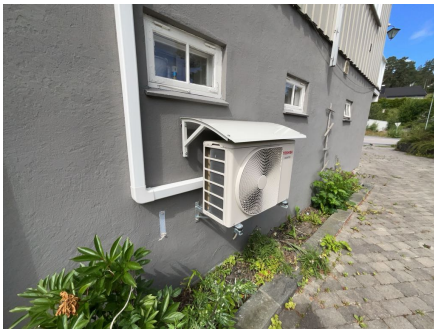
Varmepumpe utvendig komponent.
