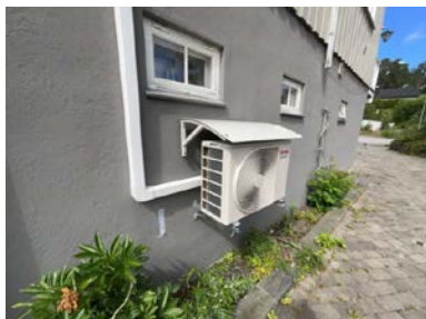
Varmepumpe utvendig komponent.
