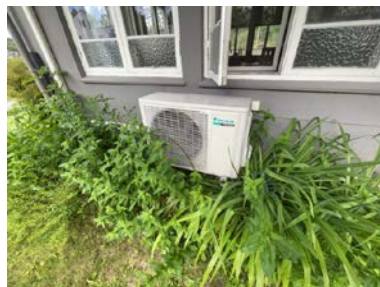
Varmepumpe utvendig komponent.
