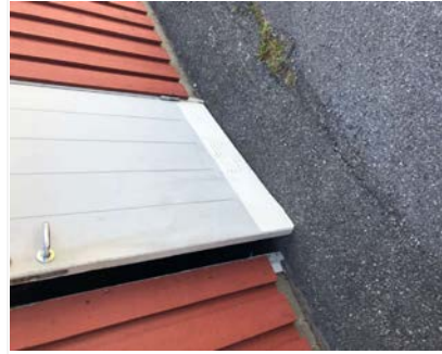
Dør som subber mot terreng
