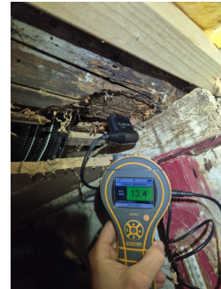
Det er målt fuktinnhold i treverk på 13,4 vektprosent, som anses som tørt, men ligger i øvre sjikt.
