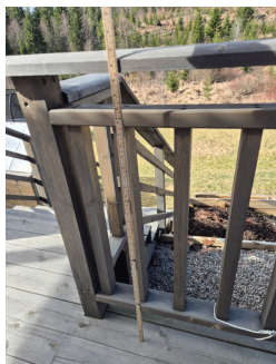
Rekkverkshøyde under dagens krav.
