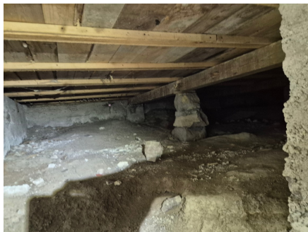
Ingen fuktsperre mot grunn.
