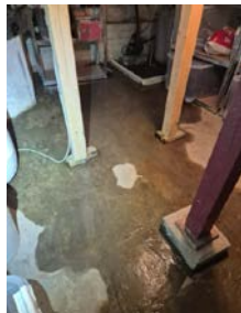
Synlig vann på gulv i krypkjeller.
