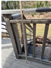
Rekkverkshøyde under dagens krav.
