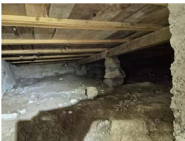
Ingen fuktsperre mot grunn.
